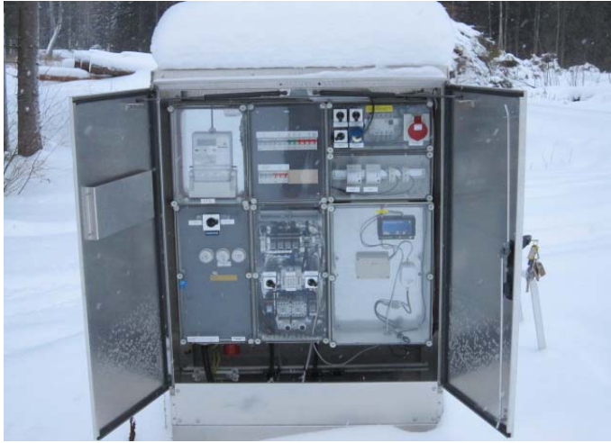
Kuva 2. Pumppaamon ohjauskeskus säänsuojakaapissa
