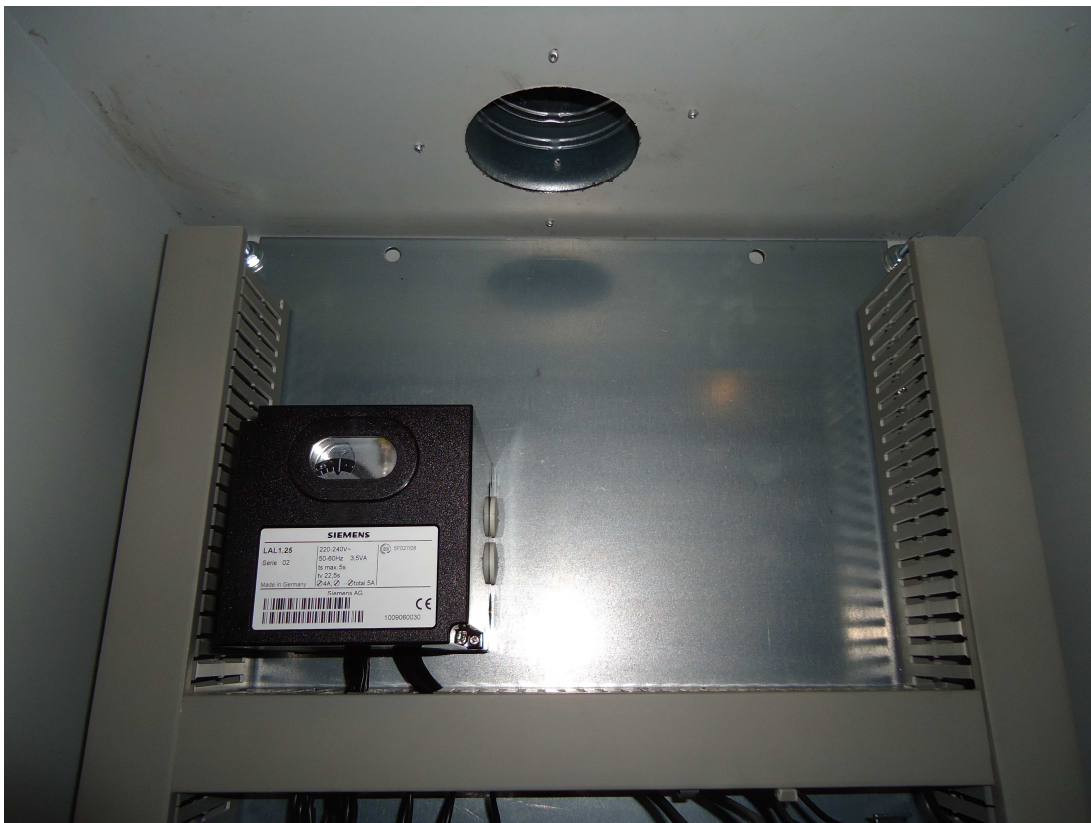
Kuva 20. Poltinkaapissa LAL 1.25 ohjausyksikkö ja ilmastoinnin tulo aukko
