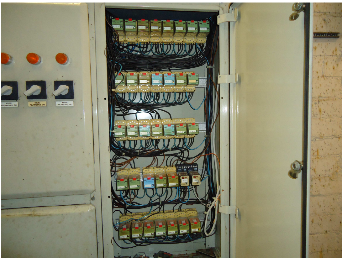
Kuva 12. Pääkeskuksessa sijaitsevat ohjainreleet
