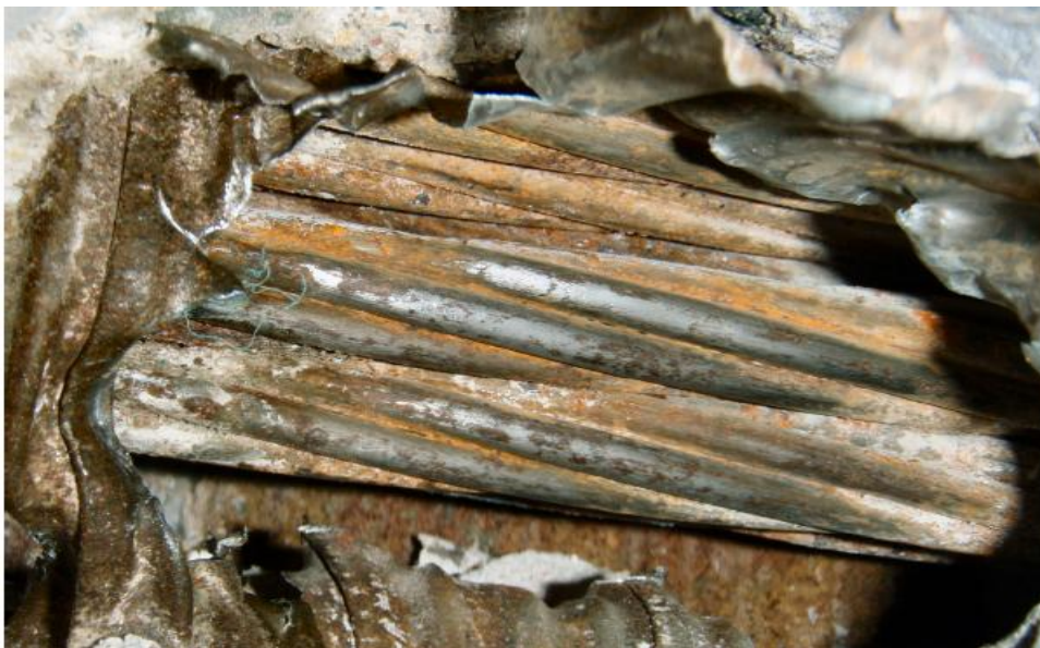
KUVA 13. Jänneterästen korroosioaste puhdistettuna 3A
