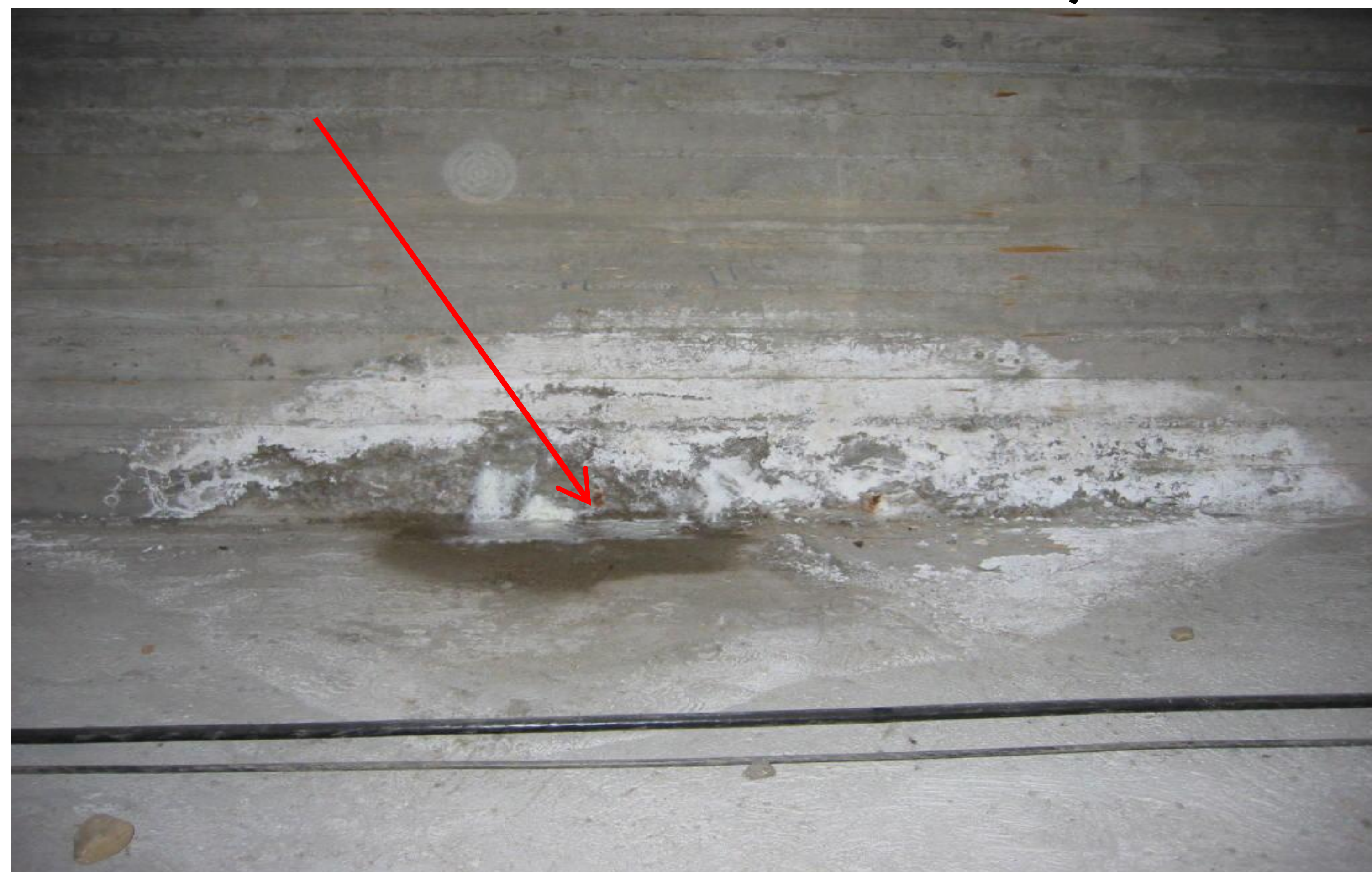
KUVA 1. VESIVUOTO SUOJAPUTKEN KOHDALLA KOTELOPALKISSA
