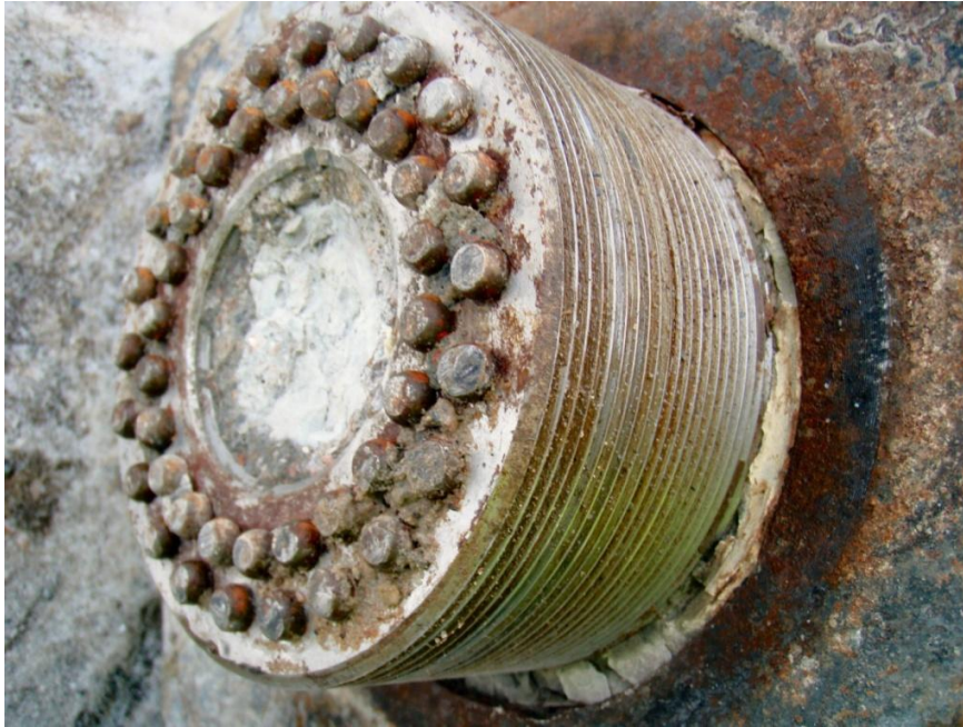
KUVA 5. Ruostumisvaurioita ankkurissa, Mälkiän silta (11)
