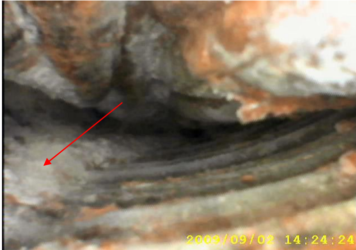
KUVA 12. Kalkkia suojaputken pohjalla
