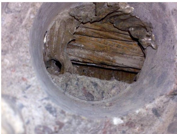
KUVA 10. Injektointimassa puuttuu kokonaan suojaputkesta
