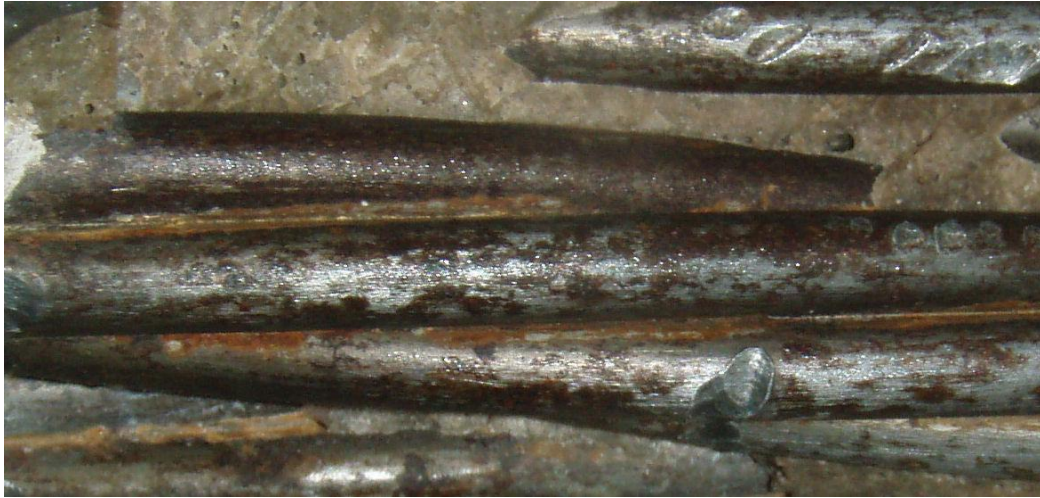
KUVA 12. Ruostetta ja syöpymiä jänneteräksissä
