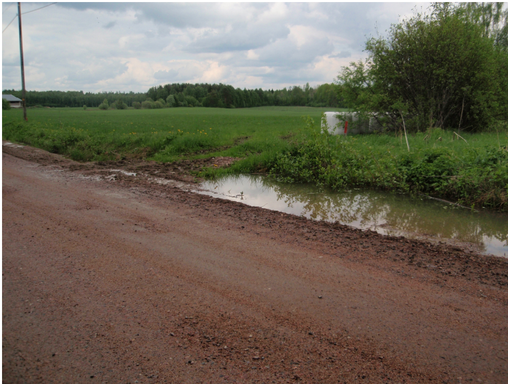
KUVA 5. Maatalousliittymän rumpu tukossa (Kuva: Pasi Kivioja)
