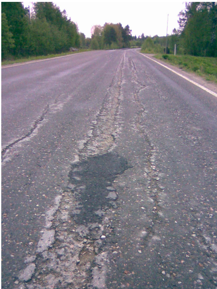
KUVA 7. Päälystevaurio tiellä (Kuva: Pasi Kivioja)
