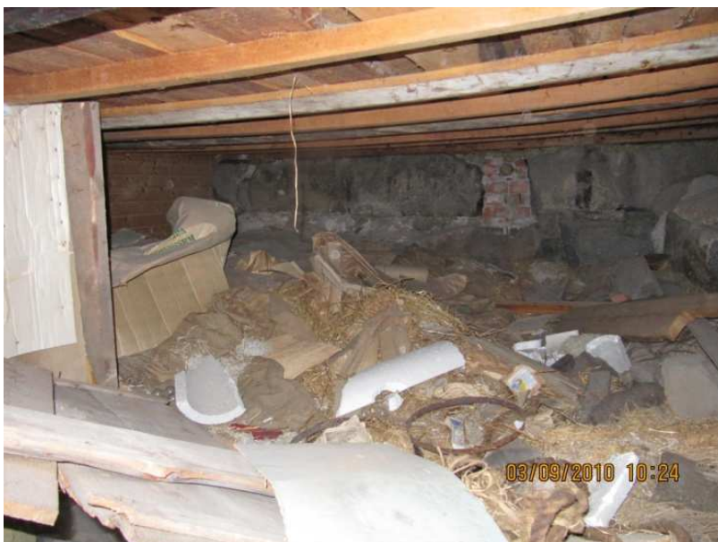
Bild 6. Kryprummet under byggnaden var fullt av skräp.
