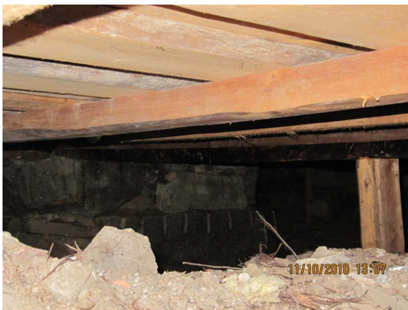
Bild 8. Primärbalkens deformation och försöken till att stämpa upp balken.
