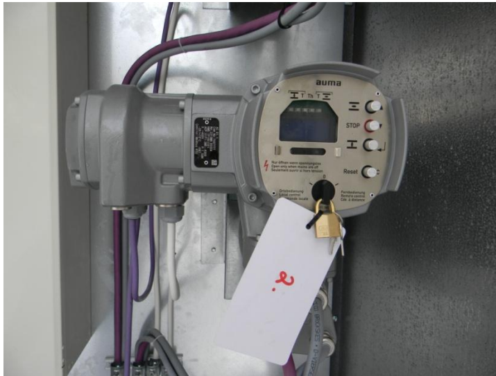
KUVA 25. Aumatic toimilaitteen paikallisohjausyksikkö
