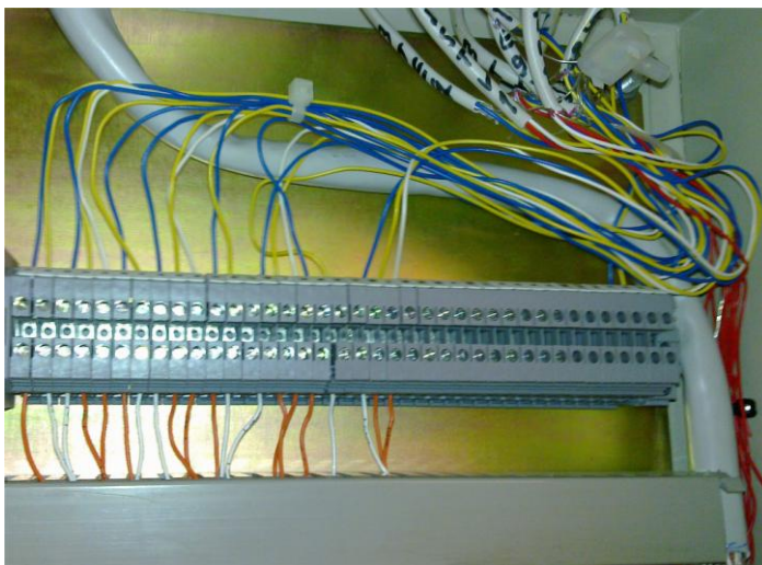
Kuva 17. Ristikytkentä vanhassa säätölaitekotelossa.
