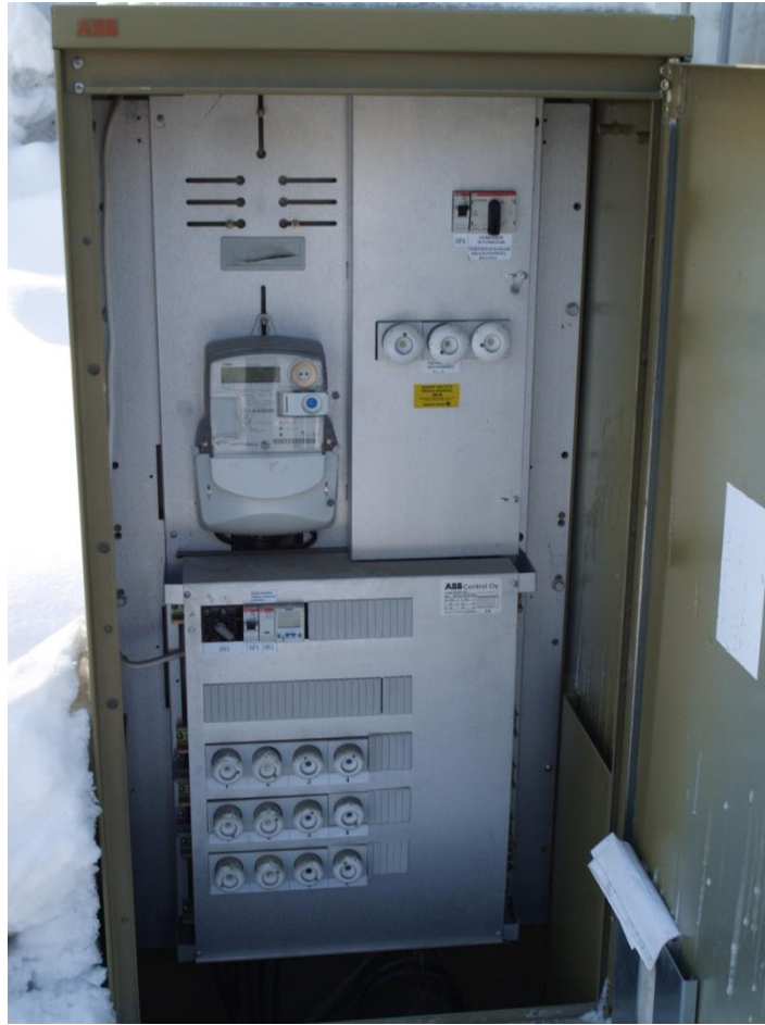
Kuva 10 ABB MCSV 96J, omalle jalustalleen sijoitettu katuväläistuskeskus.
