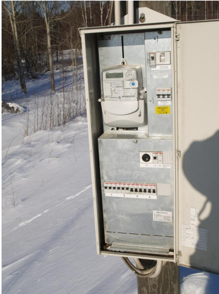
Kuva 9 Pylväässä oleva keskus.
