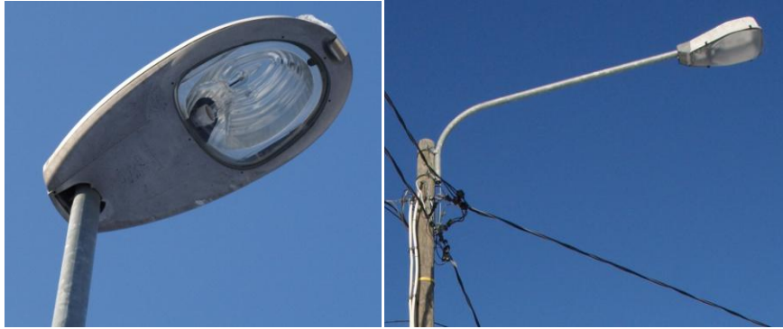
Kuva 6 Suoraan pylväässä sekä valaisinvarressa kiinni oleva valaisin.
