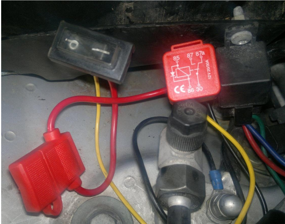
Kuva 27. Releet, varoke ja poiskytkin asennusvaiheessa
