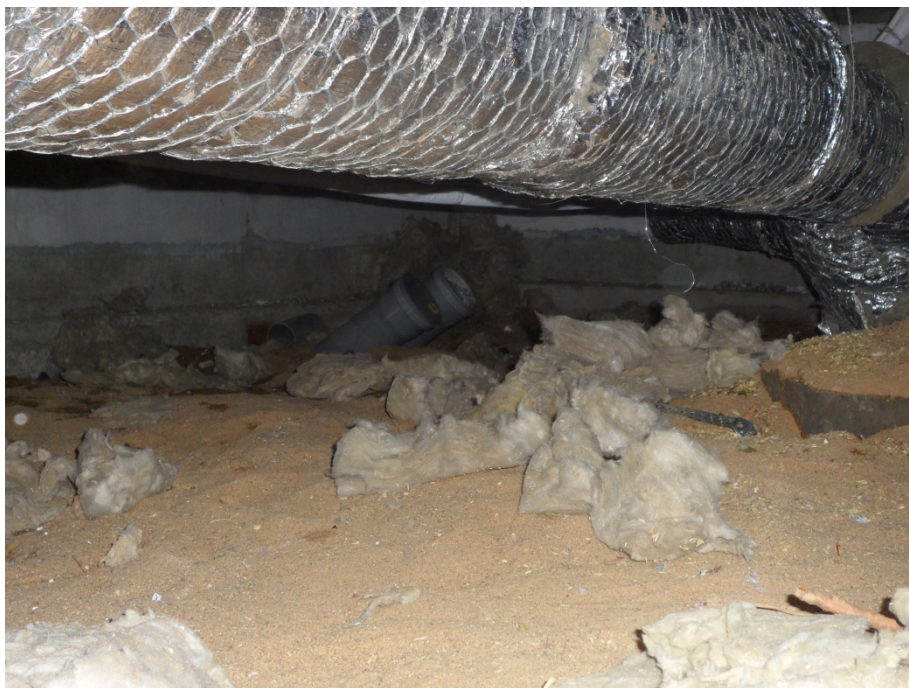
Bild2. Byggavfall kvar i kryppgrunden.
