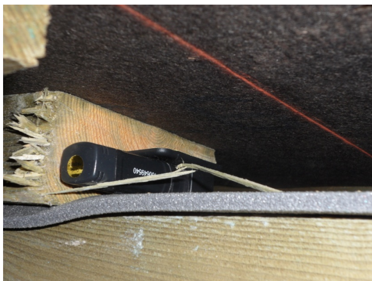
Bild 7. Mätare placerad intill bjälklaget.
