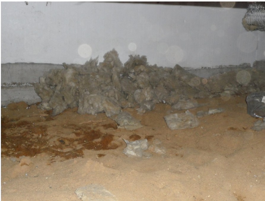
Bild1. Bergull i krypgrunden.
