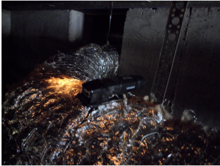
Bild 3. Mätare på ett isolerat rör i krypgrunden. (Mitten)
