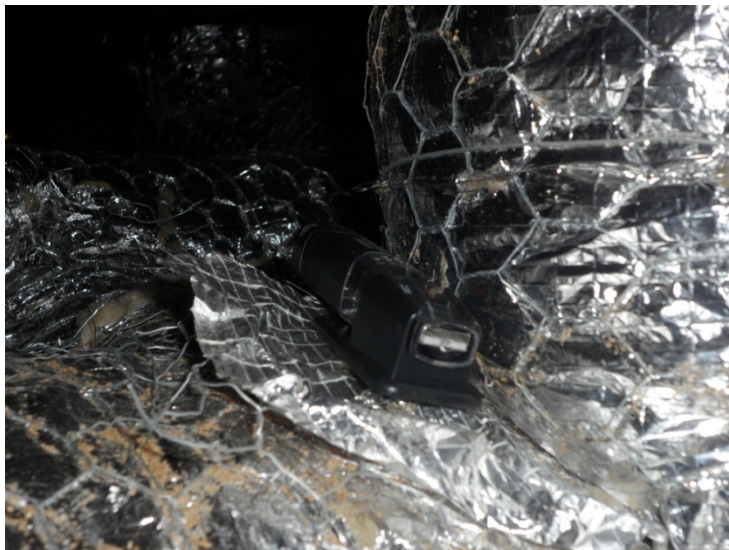
Bild 9. Mätare på rör i krypgrund.
