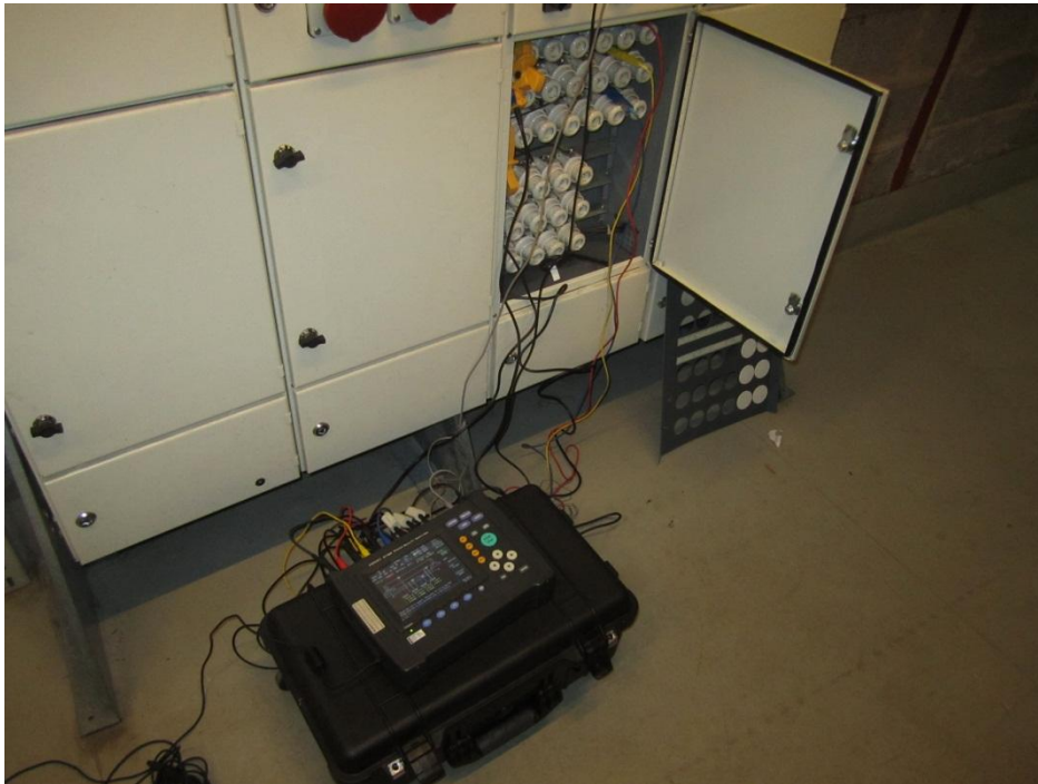
Kuva 21. Sähkönottotehon mittaus Hioki 3196-tehoanalysaattorilla.
