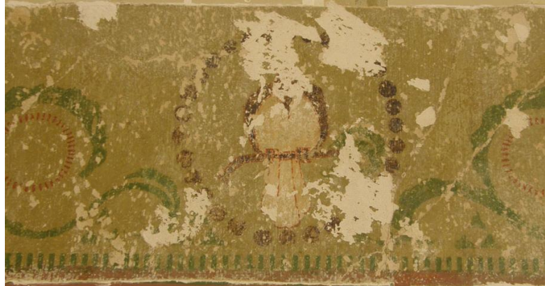
Kuva 7. Seinämaalauksen vauriokuva. Valkoiset alueet ovat silotteen täyttämää vanhoja koloja. Vaaleanruskeana näkyvät pienet kolot ovat uudempia vaurioita. Ruskea väri on paikoitellen kulunut pois. Pinnassa näkyy myös pystysuuntaisia halkeamia.
