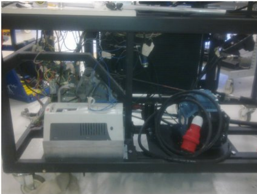
KUVA 43. Sähkömoottori ja taajuusmuuntaja
