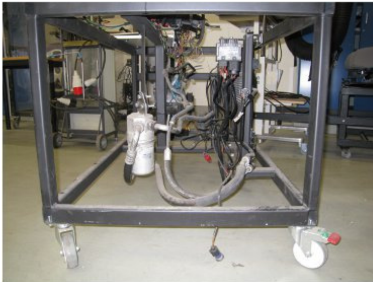
KUVA 51. Simulaattorin alkuperäinen putkisto
