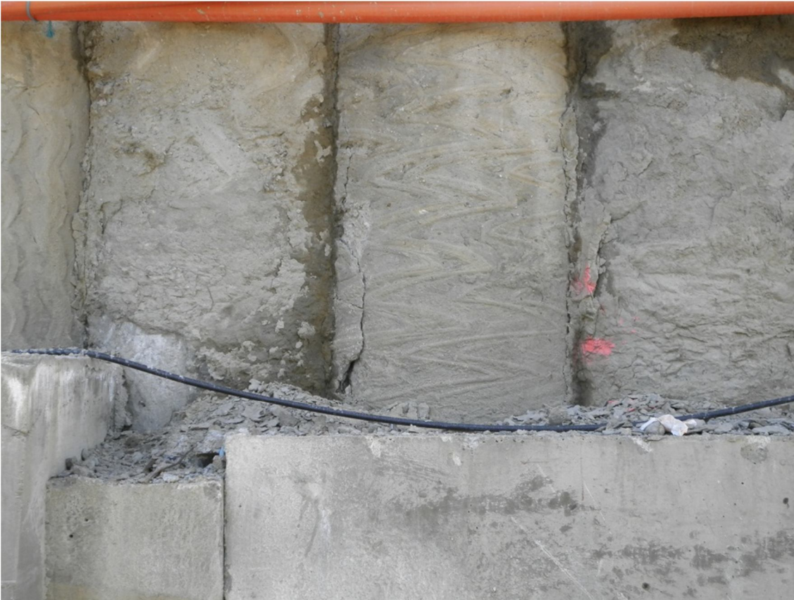
Kuva 35. Kuvan keskellä olevasta raudoittamattomasta paalusta on lohjennut pala vierestä vasemman puoleista paalua tehtäessä. Kuva: Risto Savolainen
