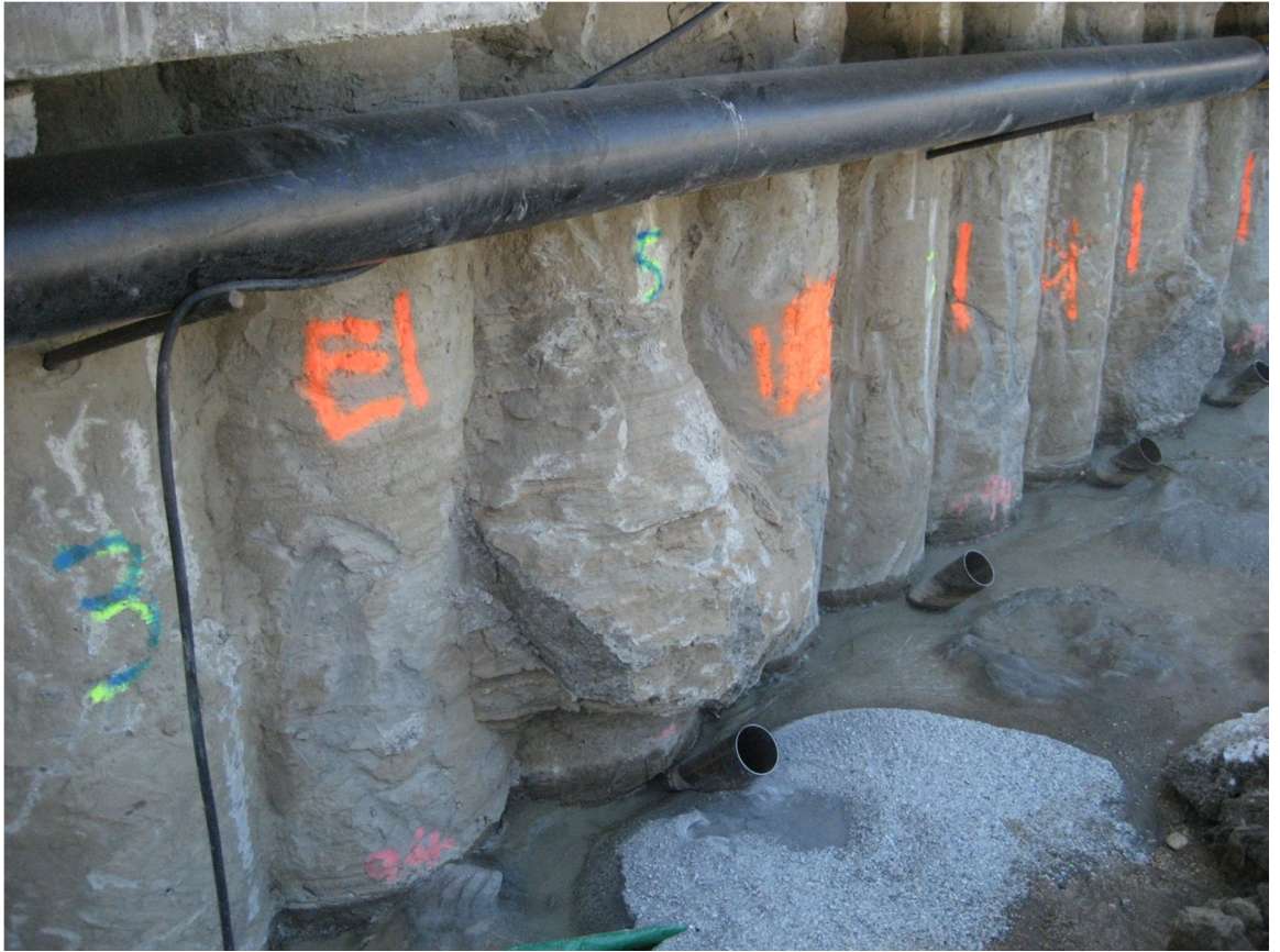
Kuva 23. Kuivaan ja löyhään hiekkamaahan on muodostunut kuiva onkalo todennäköisesti paalukaivantoa kaivettaessa. Betonoinnin ja työputken poistamisen yhteydessä onkalo on täyttynyt betonilla ja paaluun on muodostunut pullistuma. Kuva: Risto Savolainen 2010
