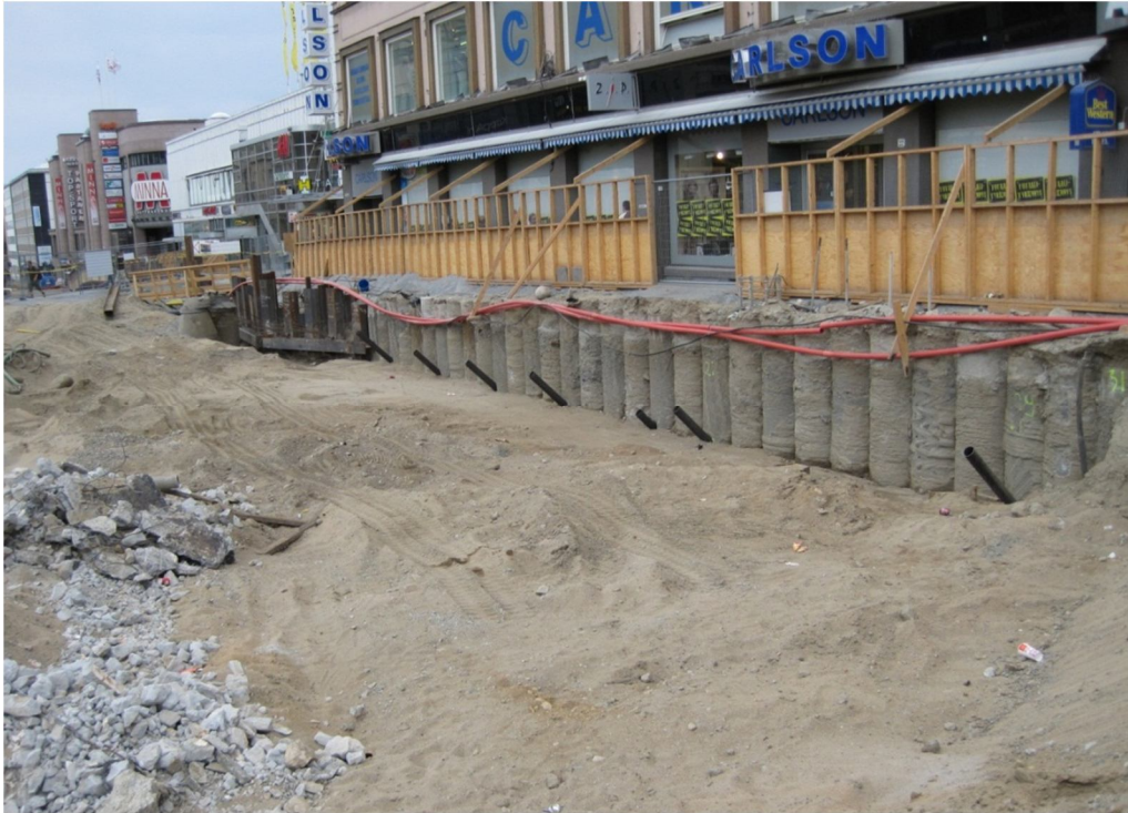
Kuva 21. Ankkureita varten porattuja suojaputkia seinäosuuden ensimmäisellä ankkurointitasolla. Vaijeripunoksia ei ole vielä asennettu. Kuva: Risto Savolainen 2010
