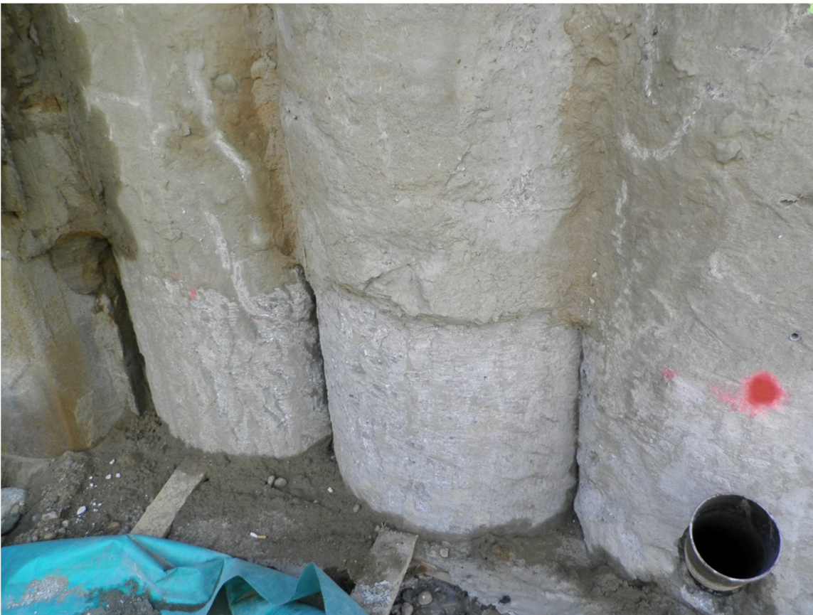
Kuva 33. Paalujen pinnassa oleva sementistä ja hiekasta koostuva kerros. Alaosasta kerros on poistettu, ja kiinteä betonipinta on näkyvissä. Kuva: Risto Savolainen
