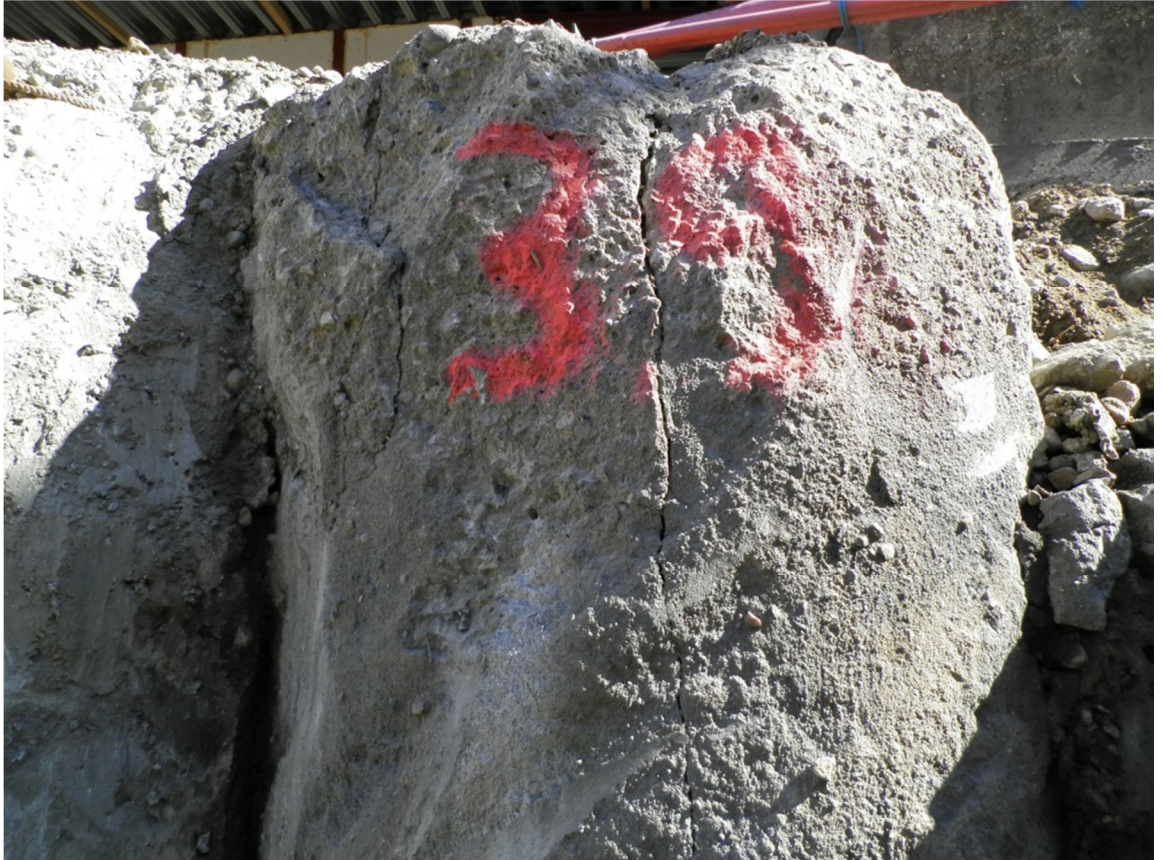
Kuva 34. Raudoittamattoman paalun keskellä oleva halkeama. Myös paalun vasemmassa reunassa on pienempi halkeama. Kuva Risto Savolainen
