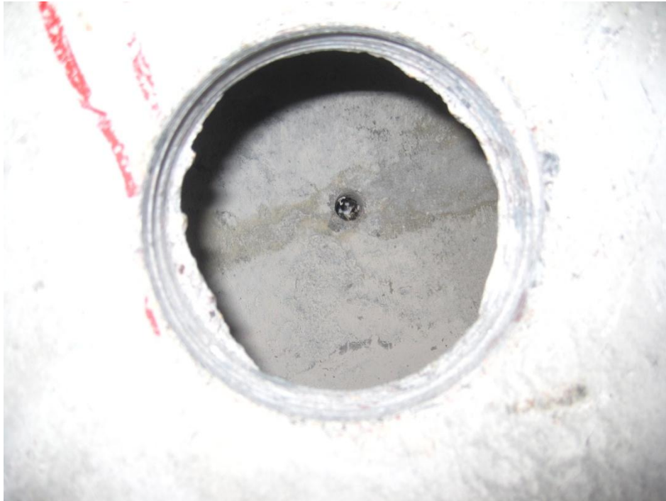
KUVA 7. Vuotokohta ontelolaatassa (Kuva: Timo Mäkinen 2011)
