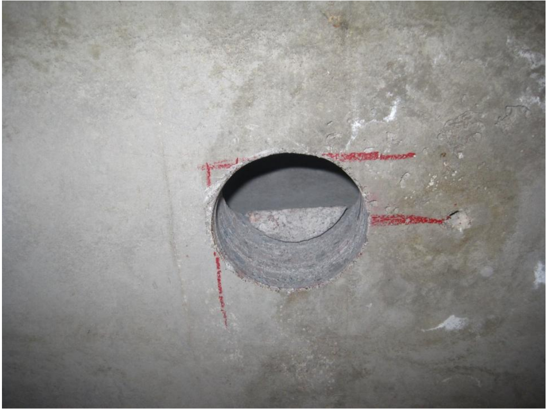
KUVA 5. Onteloon tehty reikä (Kuva: Timo Mäkinen 2011)
