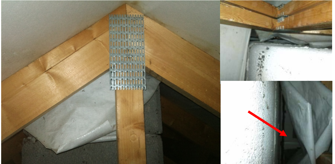
KUVAT 10, 11 ja 12. Hormin läpivienti aluskatteessa on puutteellinen Valokuva Pasi Kanerva 2010
