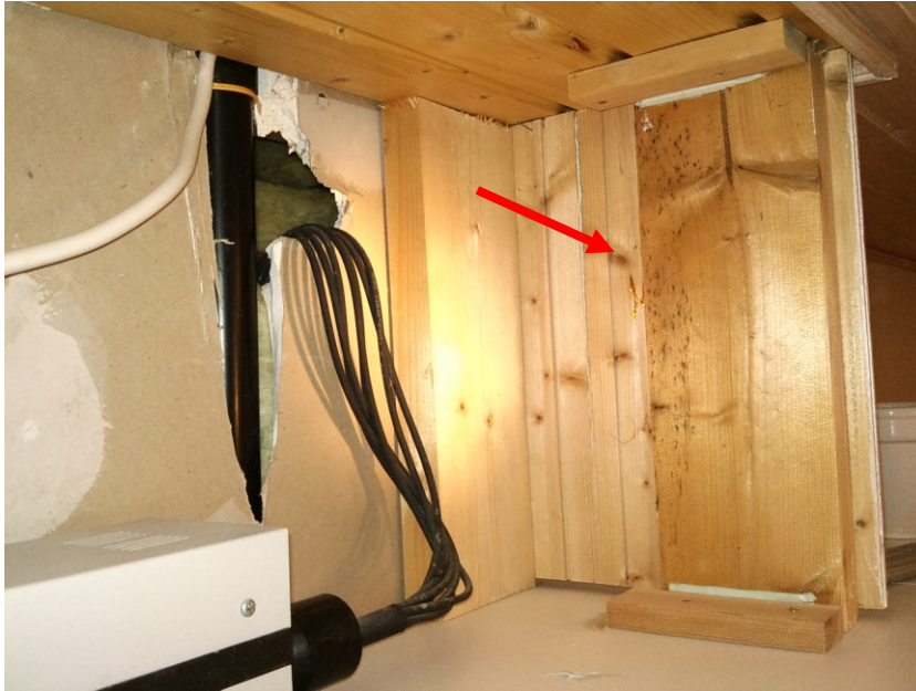
KUVA 23. Kuivauskaapin yläpuolisen kotelon sisällä on näkyvää mikrobikasvustoa. Valokuva Pasi Kanerva 2010
