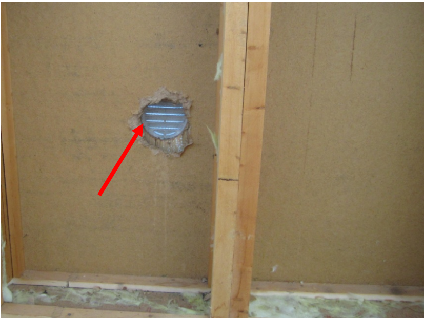
KUVA 14. Ylätilan tuuletusaukko on riittämätön Valokuva Pasi Kanerva 2010
