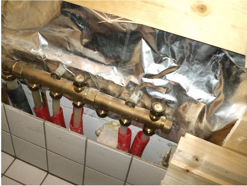
KUVA 4. Lämpimän käyttöveden kierron jakotukki saunassa Valokuva Pasi Kanerva 2010
