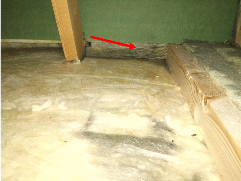
KUVA 17. Välipohjan lämmöneristeet ovat värjäytyneet
