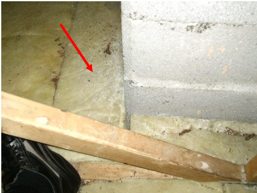
KUVA 13. Lämpöeristeissä hormin ympärillä on valumajälkiä Valokuva Pasi Kanerva 2010
