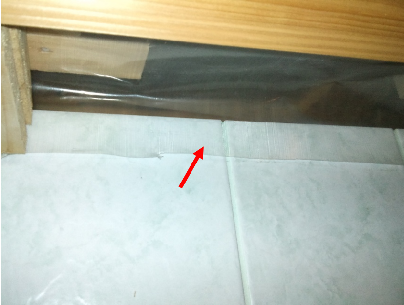
KUVA 22. Suihkuhuoneen katon höyrynsulkumuovi on tiivistetty puutteellisesti. Valokuva Pasi Kanerva 2010
