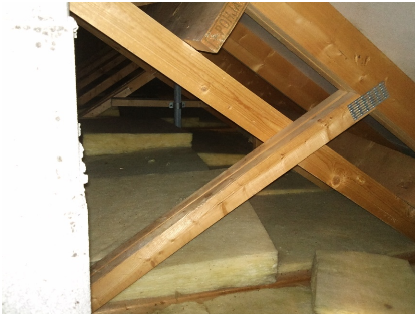
KUVA 8. Yläpohjan eristeet eivät ole kaikilta osin paikoillaan Valokuva Pasi Kanerva 2010
