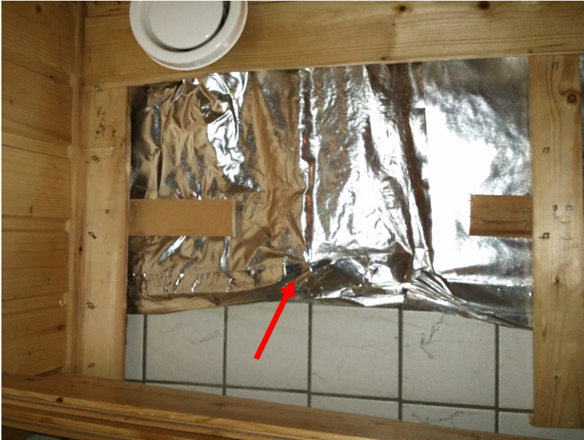
KUVA 19. Saunan alumiinipaperi on kiinnitetty puutteellisesti Valokuva Pasi Kanerva 2010
