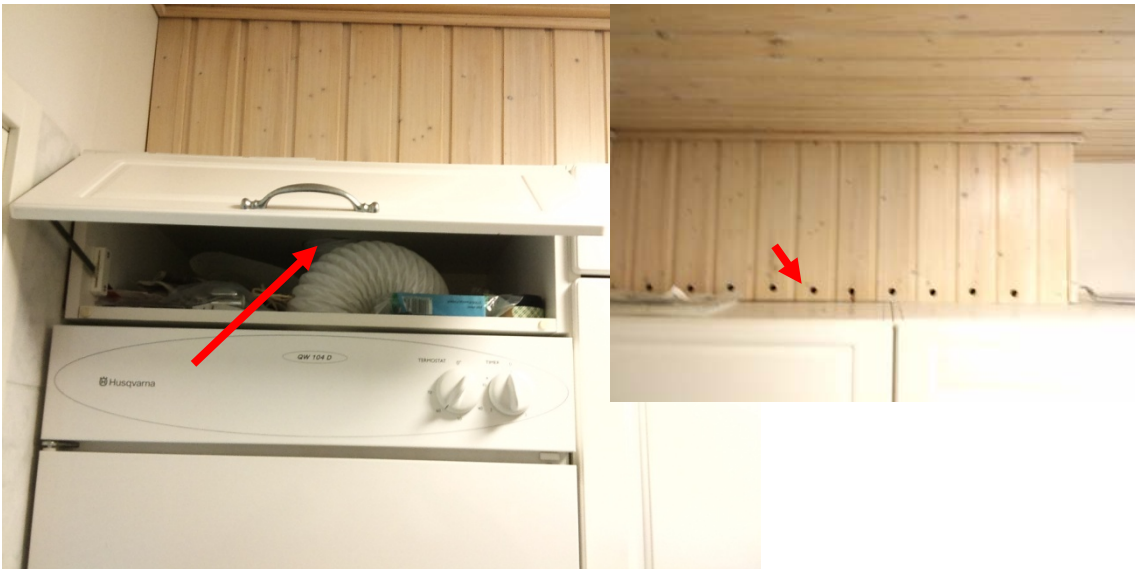
KUVAT 5 ja 6. Kuivauskaapin poistoilmaputki johtaa rakenteeseen Valokuva Pasi Kanerva 2010
