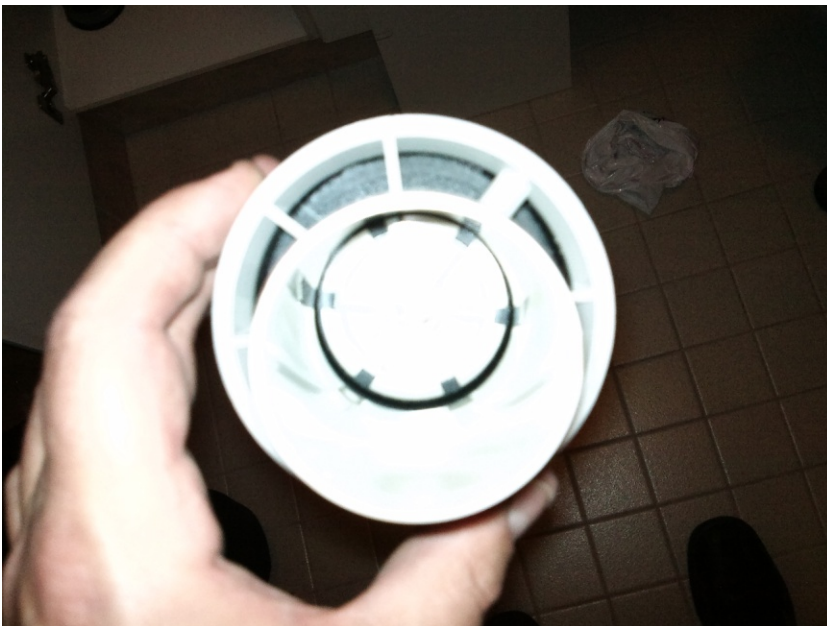
KUVA 7. Viemäroinnin alipaineventtiili yläkerran WC:stä Valokuva Pasi Kanerva 2010
