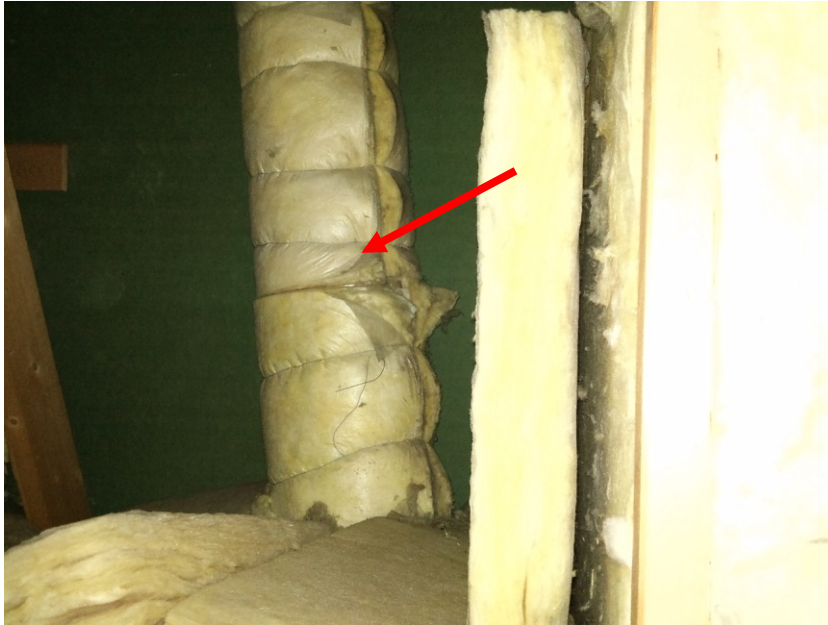
KUVA 15. Ilmanvaihtokanavien eristeissä on puutteita kylmässä ylätilassa. Valokuva Pasi Kanerva 2010
