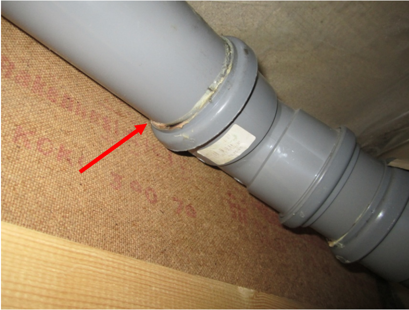
KUVA 24. Viemäriputken vuotava liitos välipohjassa.
