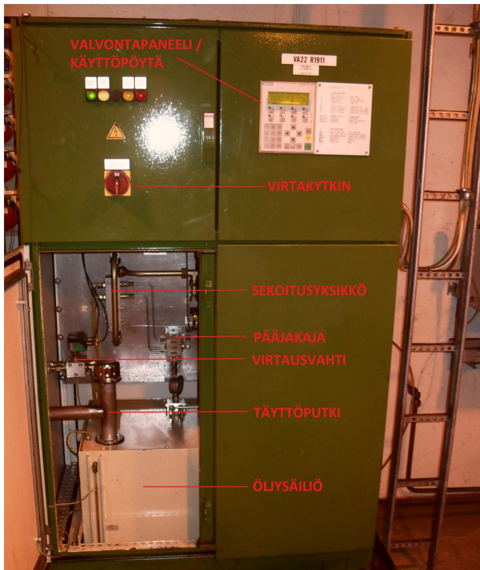
Kuva 14 Keskus sisäänrakennetulla öljysäiliöllä, kahdella pumpulla, sekä pääjakajalla että sekoitusyksiköllä.
