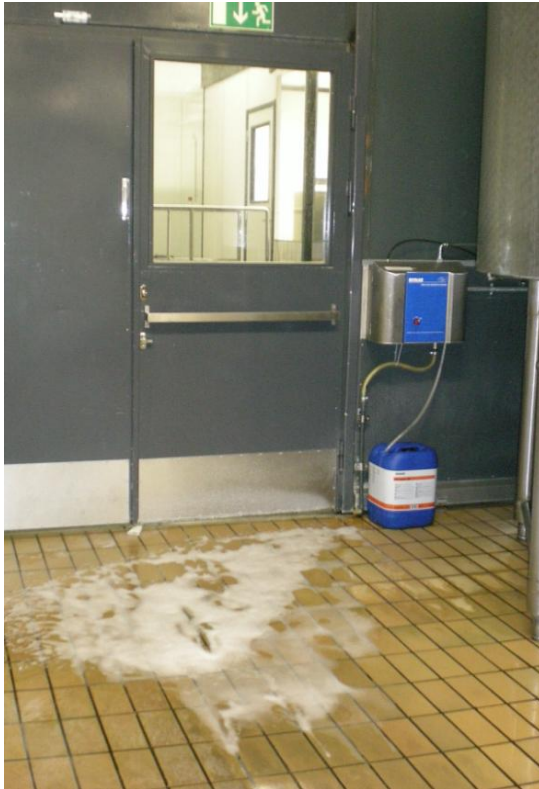
Kuva 3. Doorway Sanitation System -laite ja sen lattialle levittämä desinfiointivaahdo.
