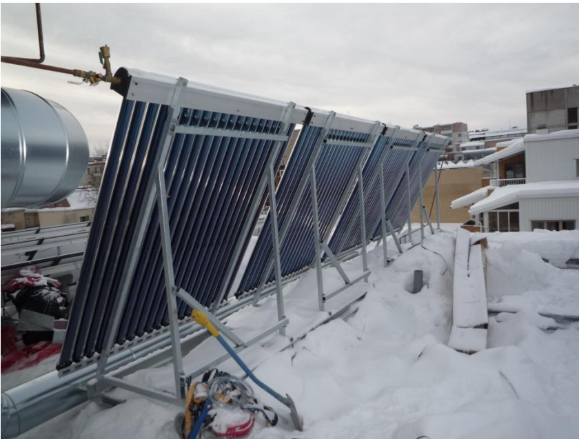
KUVA 6. Kiinteään kulmaan asennettuja keräimiä nollaenergiatalo Kuopaksen katolla. Suokatu 14 Kuopio (Valokuva Eero Saijonkari 2011)
