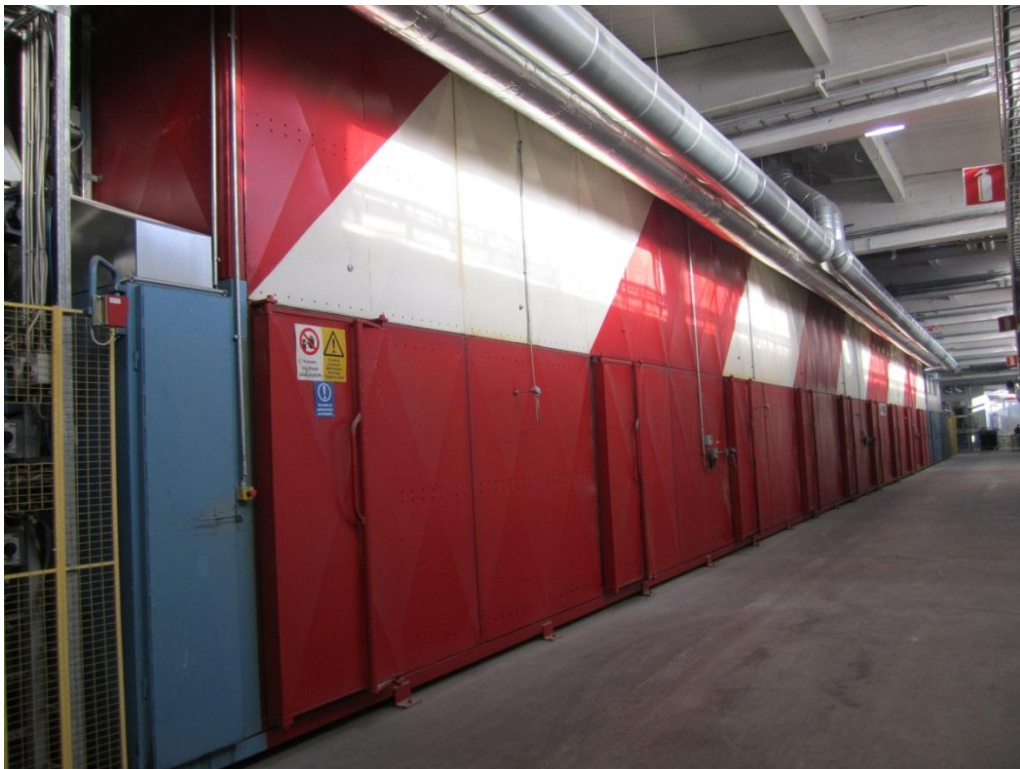
Kuva 3. Uudempi kuivausuuni kuivausosan suunnasta kuvattuna.
