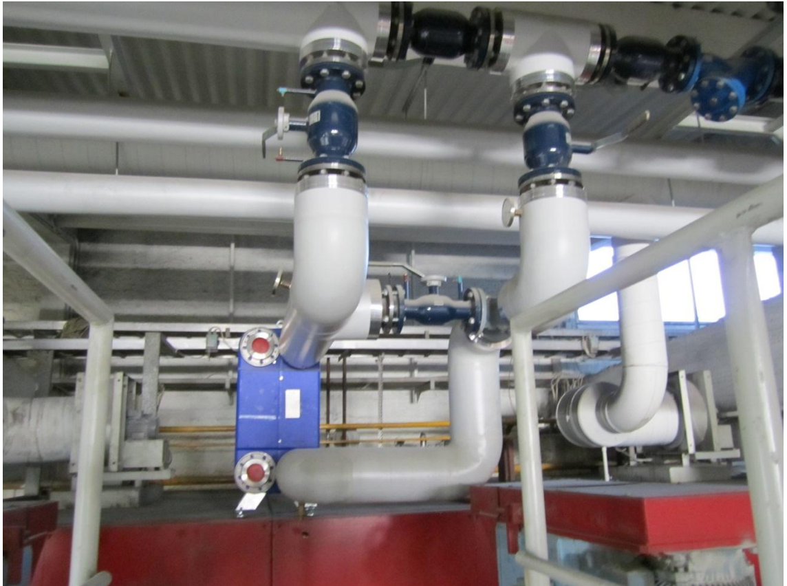
Kuva 15. Aikaisemmin asennettu vanhemman kuivaimen Alfa Laval CB200 -lämmönsiirrin ja lämmitysverkoston paluupuolelle lähtevä putkisto.
