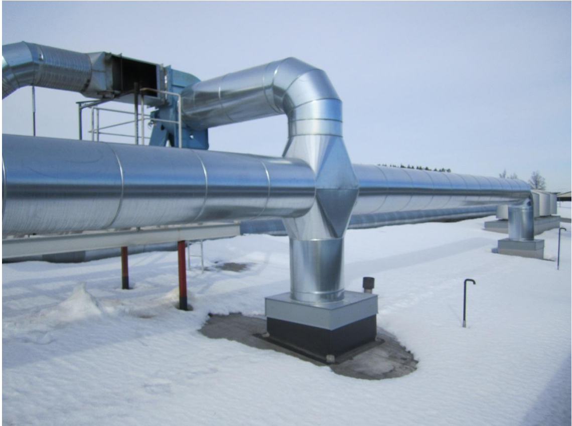
Kuva 4. Uudemman kuivausuunin (kuivaaja 2) katolla sijaitsevat poistoputket ja puhallin.
