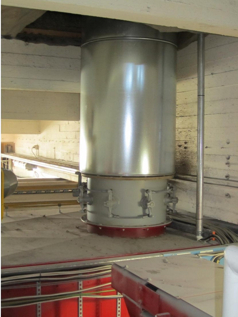
Kuva 10. Uudemman kuivausuunin yksi kolmesta poistoilmakanavasta, johon lamellipatteri tullaan asentamaan.
