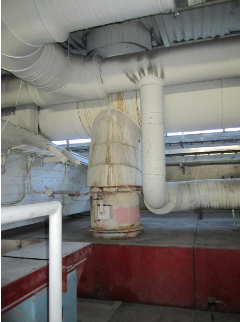
Kuva 11. Vanhemman kuivausuunin poistoilmakanava. Kuvassa näkyy myös kokoojakanava joka kulkee katon läpi huippumurille.
