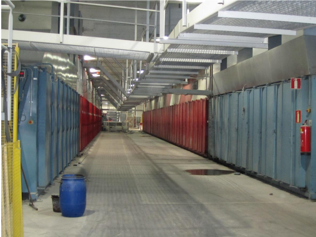
Kuva 5. Kuivausuunit jäähdytysosasta päin kuvattuna.
