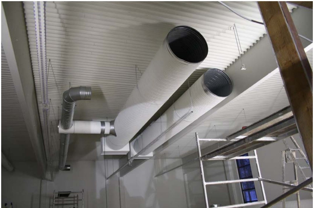
KUVA 6. Ilmanvaihtokanavia toisessa kerroksessa
