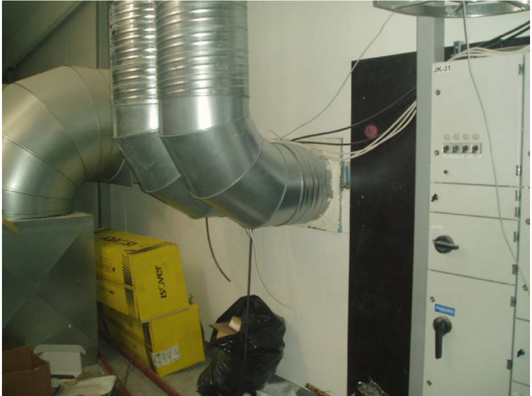
KUVA 7. Ilmanvaihtokanavia konehuoneesta ullakotilaan. Takana oleva kanavan kokoa on muutettu pienemmäksi rakennusvaiheessa
