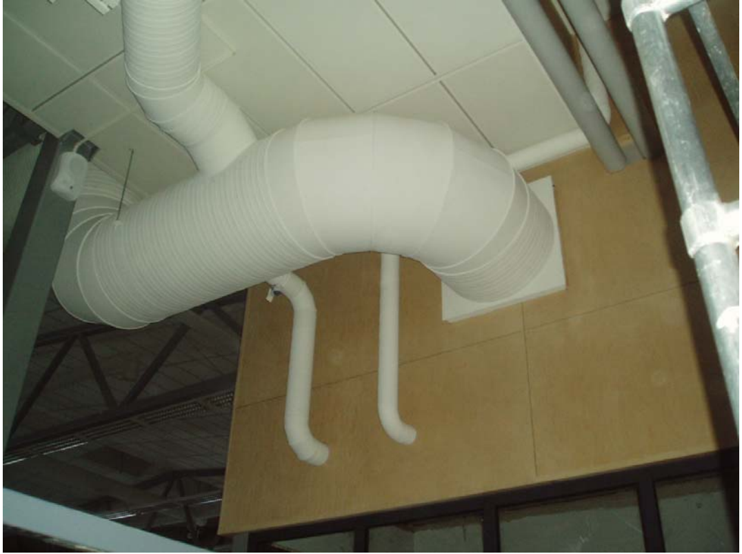
KUVA 8. Laajennusosan tuloilmakanava ilmanvaihtokonehuoneesta palloiluhallin puolelle
