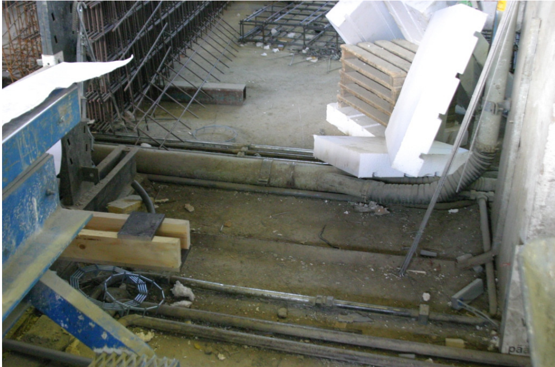
kuva 3.5. Putkia käytävällä, jolla tapahtuu jatkuvaa kulkua.
