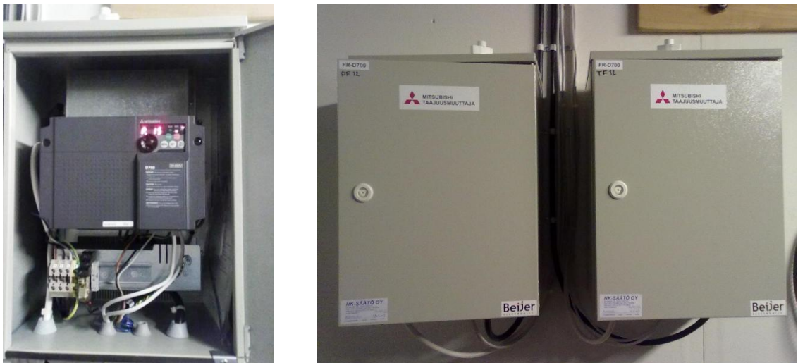
Kuva 20. Tulo- sekä poistokoneiden taajuusmuuttajat asennettiin seinälle vierekkäin.
