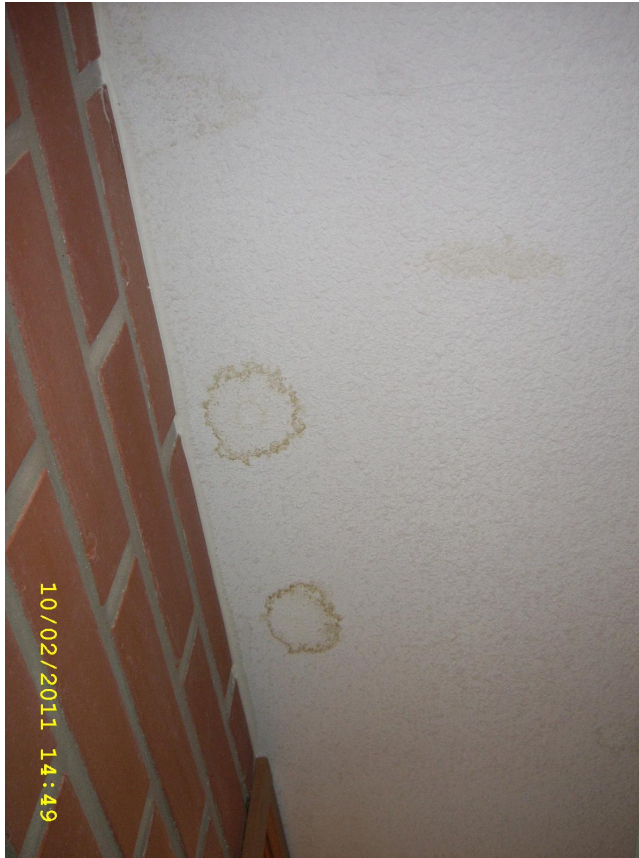
KUVA 4. Hallinto-osaston käytävän 128 katossa sijaitsevia kosteusvaurion jälkiä.
