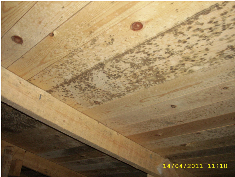
KUVA 13. Aluslaudoituksen sinistymistä pyöreän kattoikkunan ympärillä.
