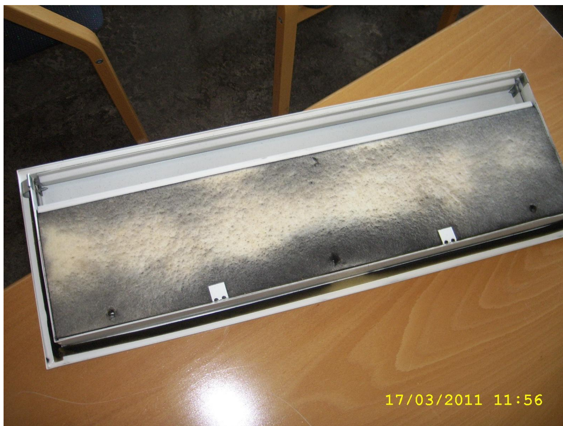
KUVA 16. Likaantunut tuloilmasäleikön suodatin.
