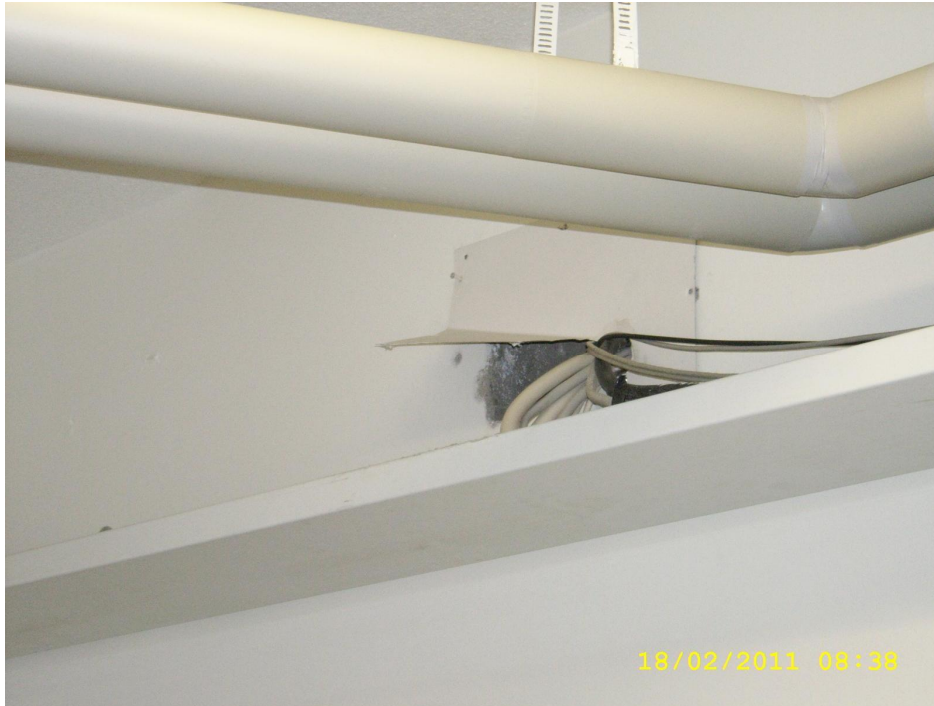
KUVA 17. Puutteellisesti asennettu palosuojapelti sähköjohtojen läpimenon kohdalla.
