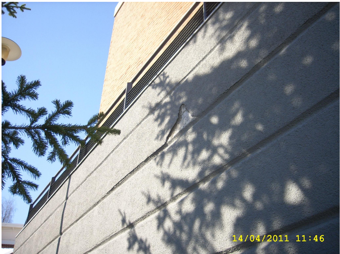
KUVA 15. Terassia ympäröivien rakenteiden rappaus on rapautunut.
