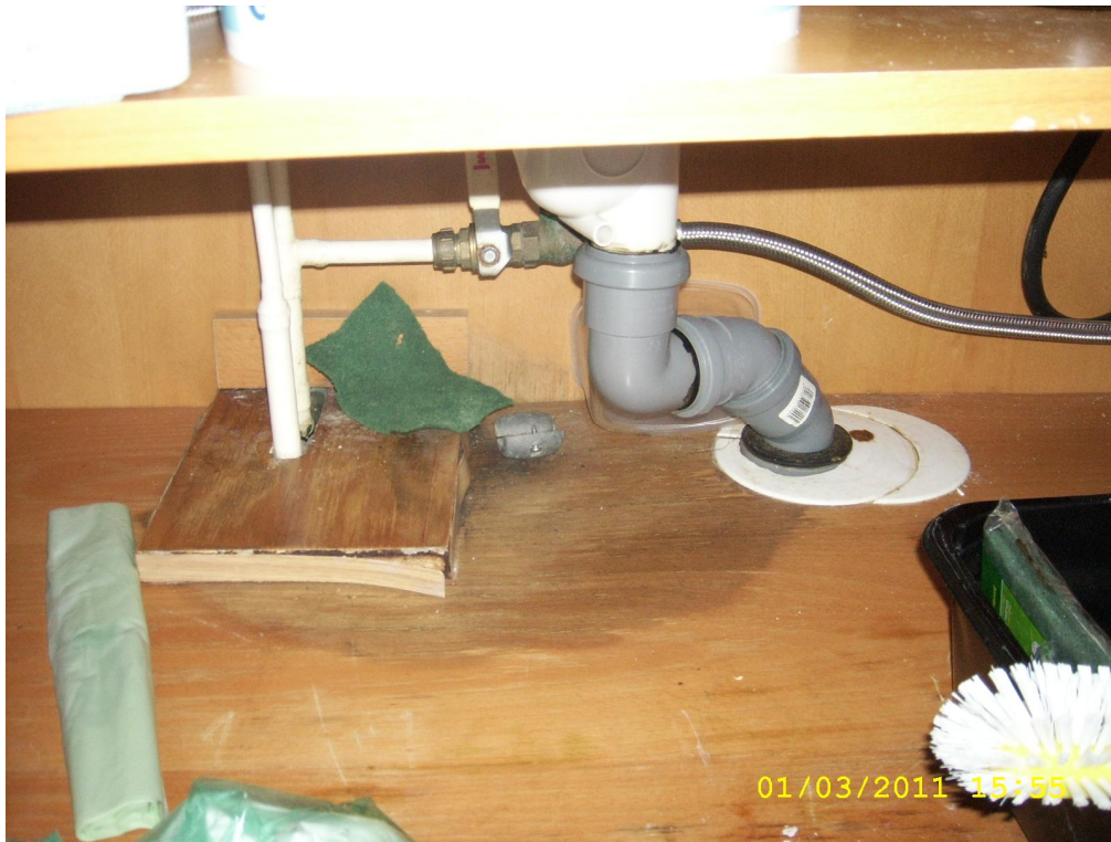
KUVA 5. Keittiön allaskaappi, joka on putkivuodon seurauksena vaurioitunut.
