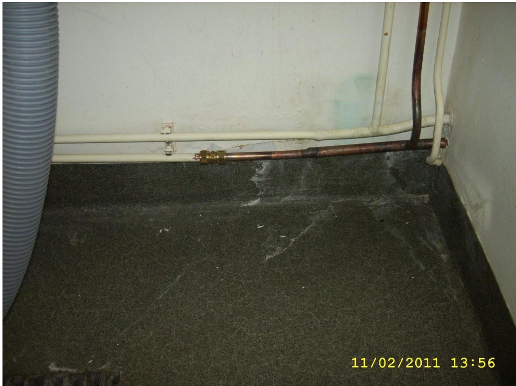
KUVA 6. Siivouskomo 1104, jossa vesivuodon aiheuttamia jälkiä. Kuvassa näkyy uusittu maalaamaton kupariputki.
