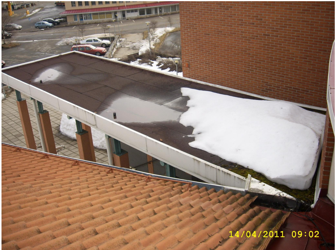
KUVA 14. Pääportaiden katoksen vedenpoisto ei toimi kunnolla ja vesi kerääntyy katolle. Katolla kasvaa myös sammalta.
