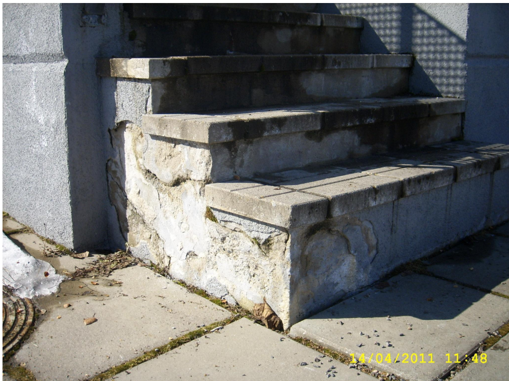
KUVA 9. Terassille johtavien portaiden rappaus ja betoni ovat rapautuneet.
