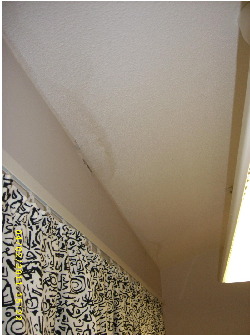
KUVA 3. Huoneessa 194 olevia kosteusvaurion jälkiä.
