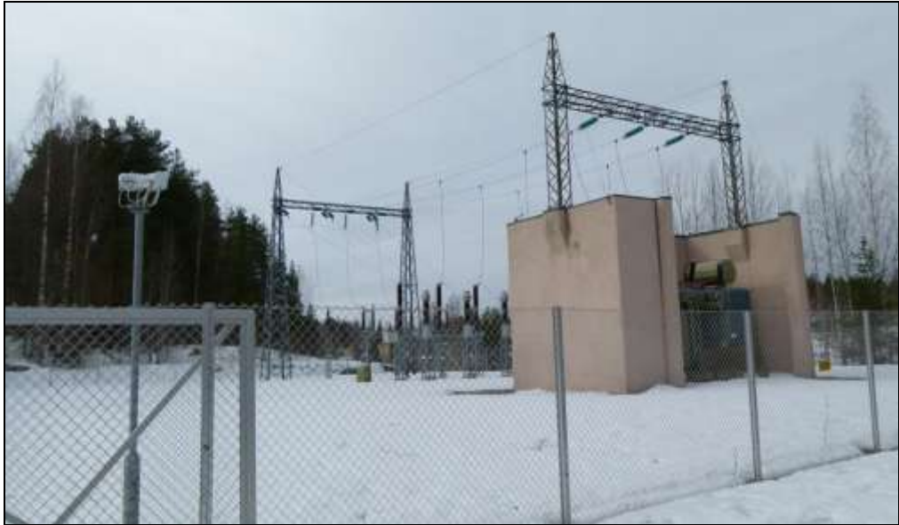
Kuva 5 Sähköasemalla on yksi 16kVA:n muuntaja. KytKentäkentällä on varattu tilaa toiselle päämuuntajalle.
