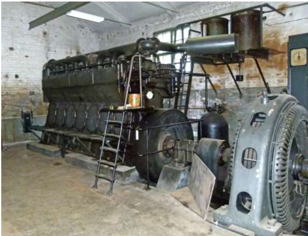
Kuva 10 Varavoima-asmalla sijaitseva vanha dieselgeneraattori /14/
