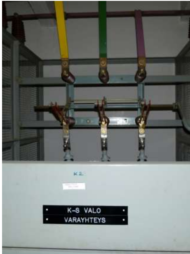
Kuva 7 Tölskän muuntamossa on erotin jolla saadaan tarvittaessa varayhteys Vattenfall Verkko Oy:n (aikaisemmin Keski-Suomen Valo Oy) kanssa /14/
