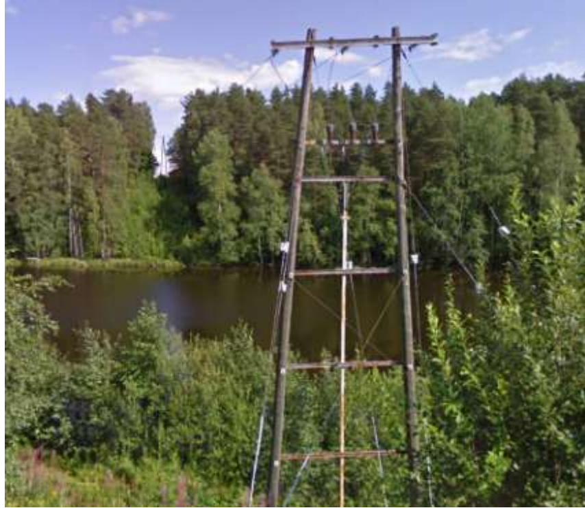
KUVA 6 Varaslahden ylittävä kj-johto lähdöllä 2 /13/
