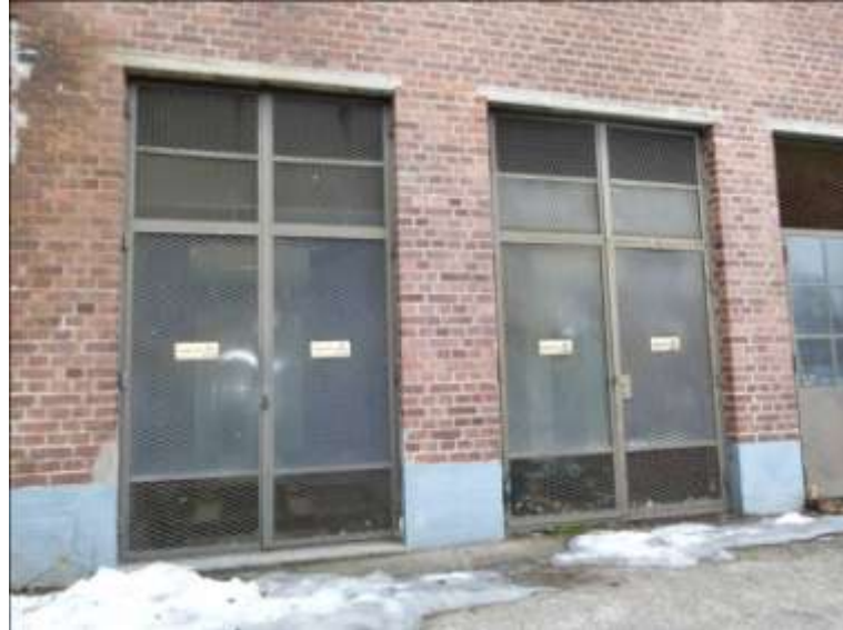
Kuva 12 Naulatehtaan muuntajat. Vasemman oven takana on 1600 kVA:n 20/0,4 kV:n muuntaja ja oikeanpuoleisen oven takana on 1000 kVA:n 3/0,4 kV:n muuntaja. /14/
