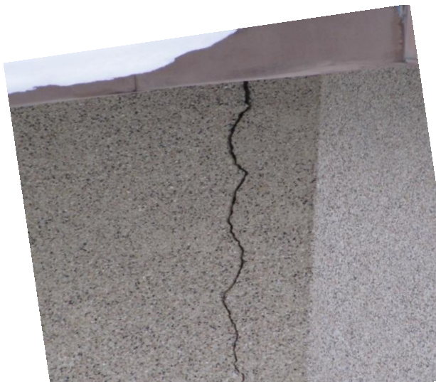
Kuva 4. Ulkoseinän pystyhalkeama Kuva Auli Hoffrén
