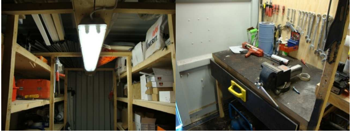
Kuva 6. Työkalukontin valaisin ja työpiste.
