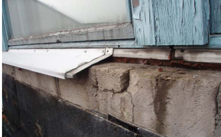
Kuva 7. Ikkunoiden huoltamattomuuden seuraukset, tosin tarkastuskierroksella tämä jäisi toteamatta, sillä tarkastuskierroksella ei ole tarkoitus rikkoa rakenteita.
