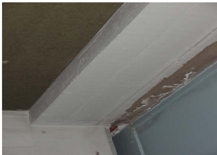
Kuva 8. Seinän ja leukapalkin vuotava liitos.
