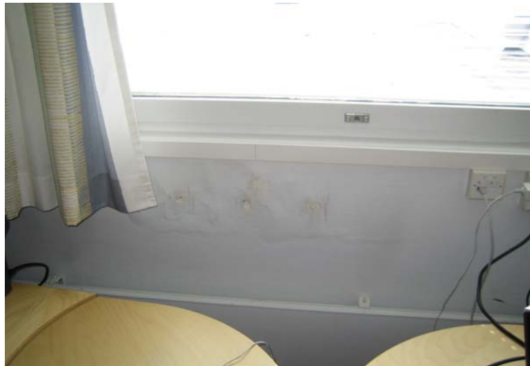
Kuva 4. Ikkunan alapuolinen seinä on tehty liian tiiviiksi lasikuitutapetilla ja maalilla.
