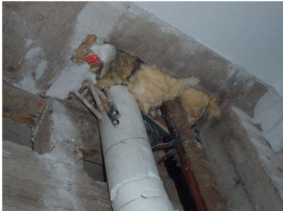
Kuva 9. LVI-tekniikan puutteellinen läpivientitiivistys.
