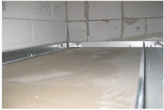
Kuva 1. Näkymä alakaton päälle, jossa vaaleaa rakennuspölyä. Puhtausvaatimus ei täyty. Valokuva Sirpa Kolari 2011.
