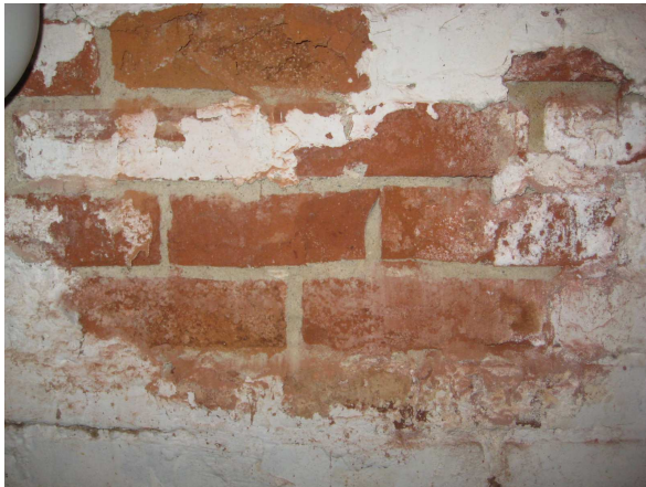
Kuva 26. Kellarin poltetut tiiliset julkisivuseinät rapautuneet n. 1,5 metrin matkalta betonilattian pinnasta.
