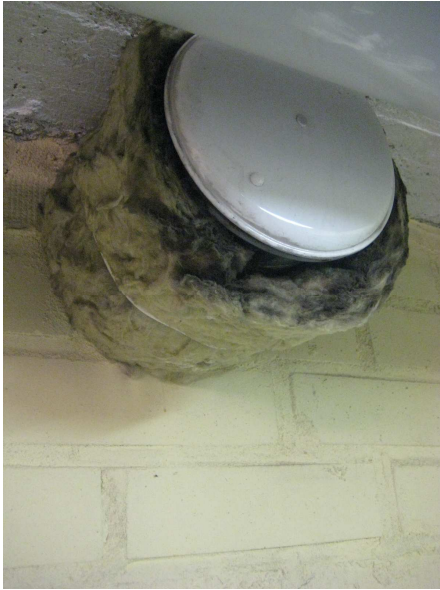
Kuva 23. Tuloilmaventtiili, jonka ympärille on kertynyt saastetta ja pölyä.
