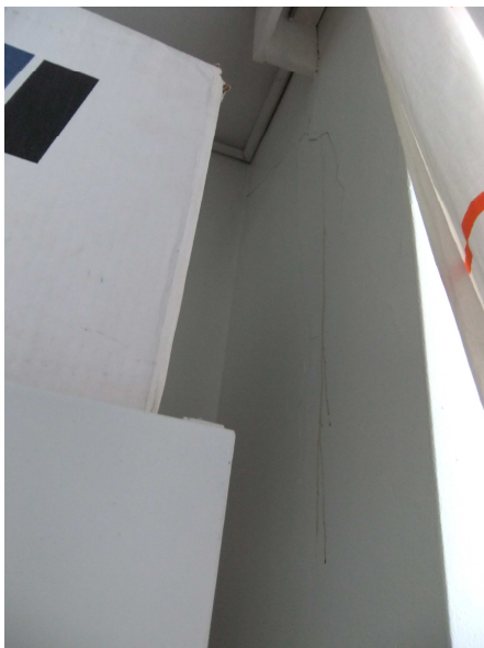
Kuva 20. Kuivunut kosteusvaluma henkilökunnan pukuhuoneessa.
