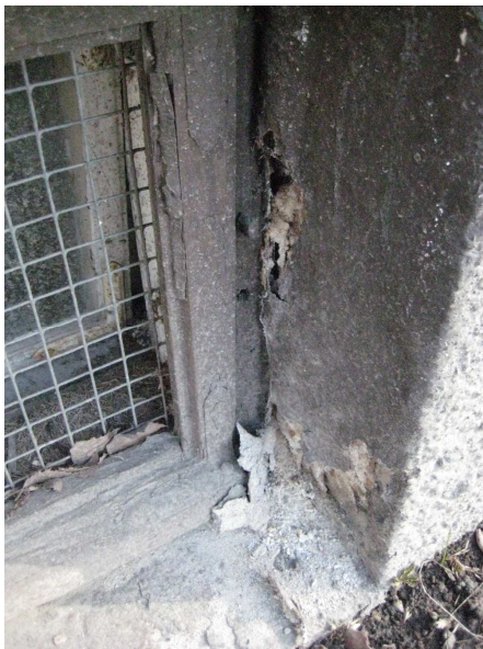
Kuva 17. Rappauspinta on irronnut ikkunan ja sokkelin rajakohdasta.
