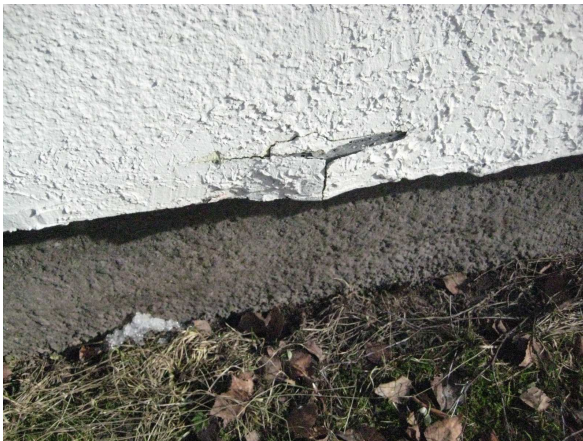
Kuva 15. Paikallisesti irronnut rappaus lounaisella julkisivulla.
