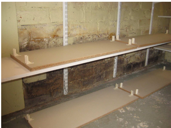
Kuva 2. Arkistohuoneen (2) takaseinä kaipaa lisätutkimuksia.
