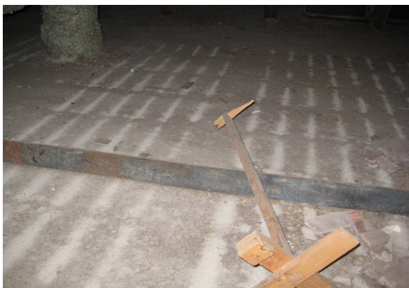
Kuva 35. Katteen alapinnassa tiivistynyt vesi on tippunut betonipintaisen yläpohjan päälle.
