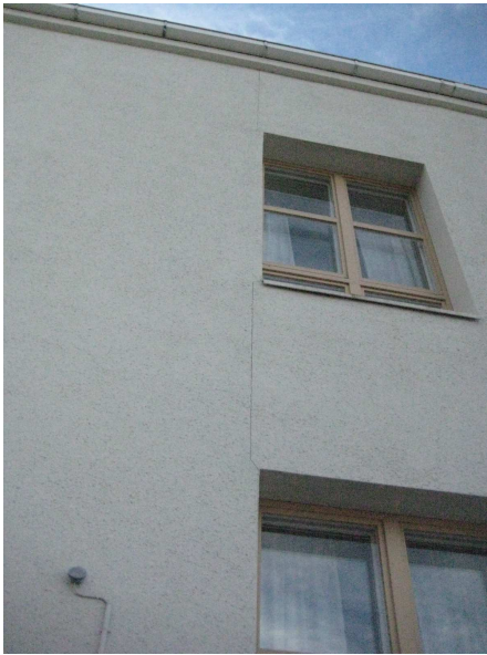
Kuva 14. Koillisen julkisivun halkeama on syntynyt, kun lattiat ovat koolatut.
