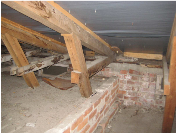
Kuva 31. Peltikatteen läpi tulevat naulat tulevat myös aluskatteen läpi.
