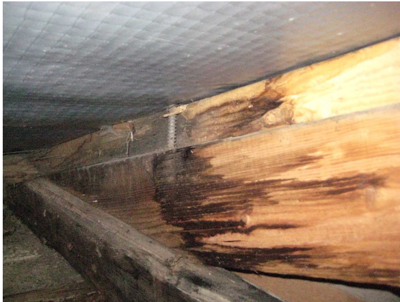
Kuva 30. Kostuneesta puuristikosta otettu kosteuslukema (25) viittasi hyvin kosteaan materiaaliin.
