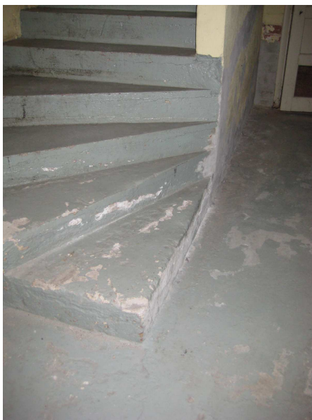
Kuva 4. Kellariin johtavat portaat ovat vaurioituneet vain kolmelta alimmaiselta rapulta.
