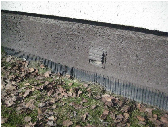
Kuva 6. Perustuksia suojaava perusmuurilevy on vain 40 cm:n korkuinen.
