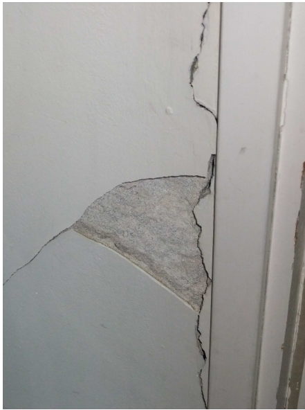
Kuva 19. Rappauslaasti on irronnut kantavasta seinästä toisen kerroksen kirjavarastossa.
