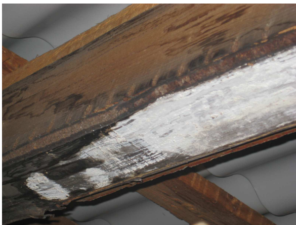
Kuva 32. Valkolahottajan aiheuttamia vauriota ullakon ristikkorakenteissa.
