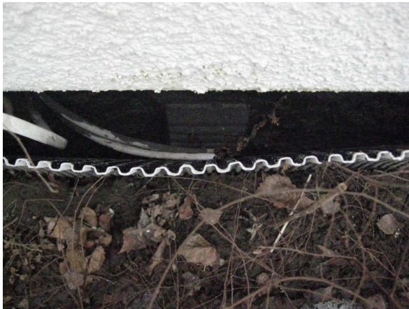
Kuva 24. Perusmuurilevy peittää arkistohuoneen (3) tuloilmaventtiilin.
