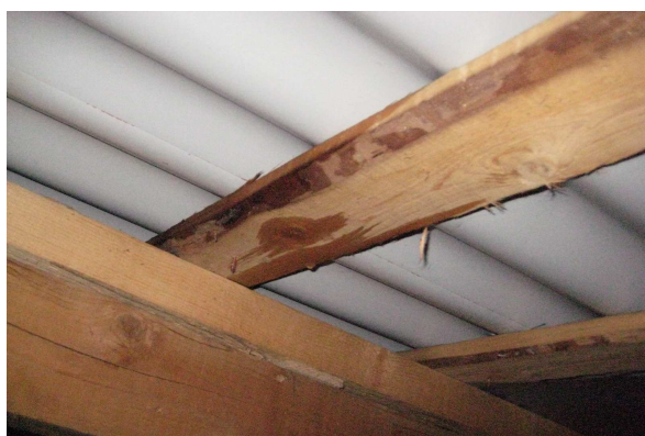
Kuva 29. Kostunut lankku katteen alla, joka johtuu naulan reiästä tulleesta kosteudesta.
