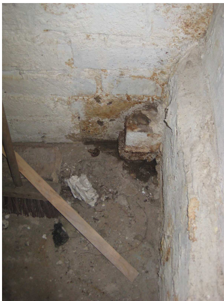
Kuva 25. Kostunut nurkka kattilahuoneessa.
