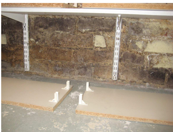
Kuva 28. Arkistohuoneessa (2) mahdollisten homesienten aiheuttamat vauriot kaipaavat lisätutkimuksia.
