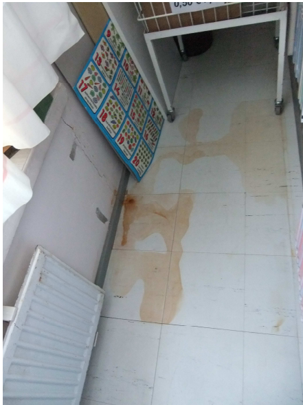
Kuva 8. Haljenneen ulkoseinän kautta on päässyt aikoinaan kosteutta välivaraston lattialle, joka pintakosteusmittausten yhteydessä osoittautui kuivaksi.
