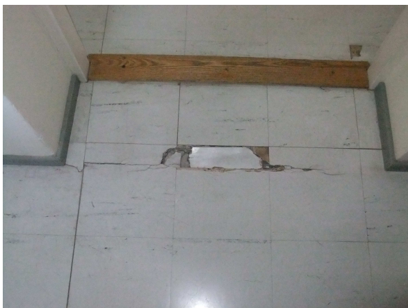
Kuva 9. Lattialaatta on murtunut kirjavaraston ja varaston välisen oviaukon kohdalta.
