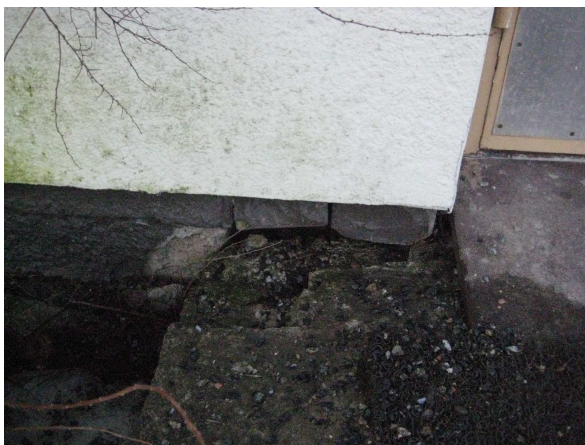
Kuva 7. Vaurioitunut perusmuuri kirjaston pääsisäänkäynnin läheisyydessä.
