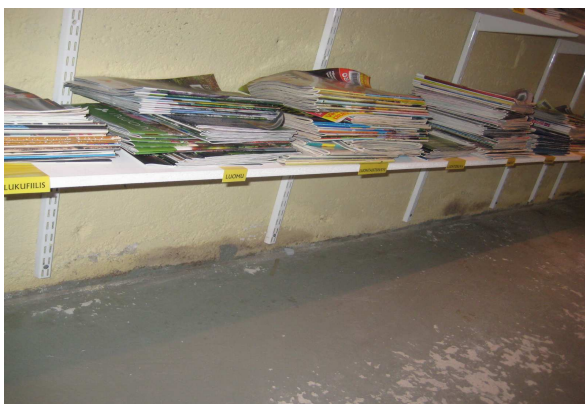
Kuva 27. Arkistihuoneen (4) väliseinässä oleva vaakasuuntainen kosteuspoikkeama sijaitsi lähellä betonilattian pintaa.
