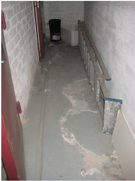
Kuva 3. Kellarin käytävällä näkyy edelleen kosteusjäljet viime tulvan jäljiltä.
