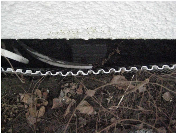
Kuva 22. Arkistohuoneen (3) tuloilmaventtiiliä peittää perusmuurilevy.
