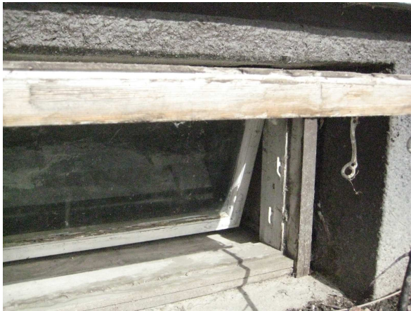
Kuva 18. Perusmuurissa oleva kellarin ikkuna lounaisella julkisivulla ei pysy kiinni.
