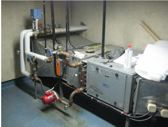
Kuva 21. Koneellinen ilmanvaihtolaitteisto sijaitsee kirjaston ullakolla.
