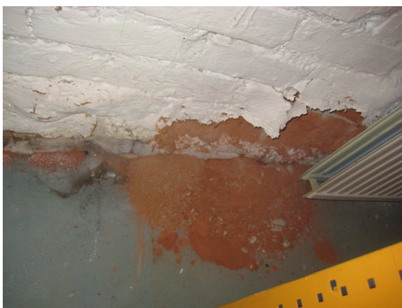
Kuva 1. Arkistihuoneen (1) väliseinästä on rapautunut tiiltä kosteuden vaikutuksesta.
