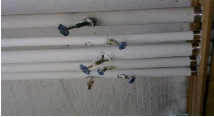
KUVA 2. Vanhoja putkistoja eristettynä asbestimassalla
