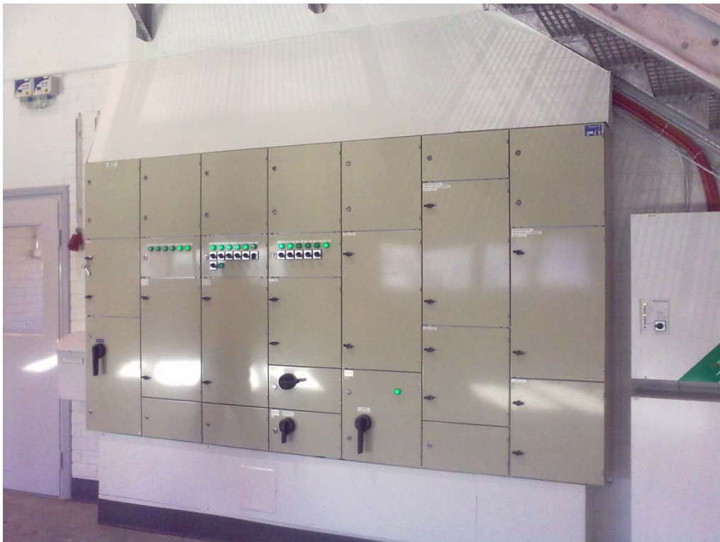
KUVA 7. JK01, jonka alapuolella pääpotentialitasauskiskoa suojaava auki ruuvattava valkoinen suojalevy
