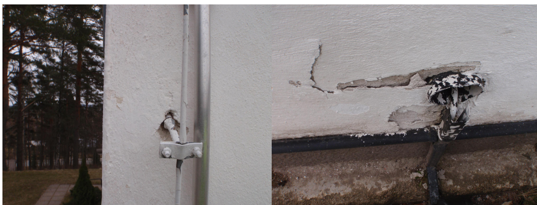
KUVIO 11. Vaurioituneita liittymiä julkisivurappauksiin
