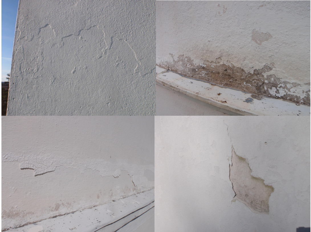
KUVIO 8. Julkisivun pinnoitevauriota ja rapautumisvaurioita
