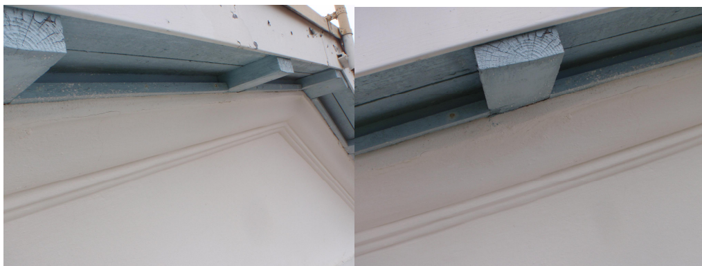
KUVIO 2. Valokuvia räystäslinjan koristerappauksista
