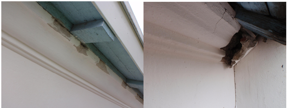
KUVIO 9. Vaurioita koristerappauksissa
