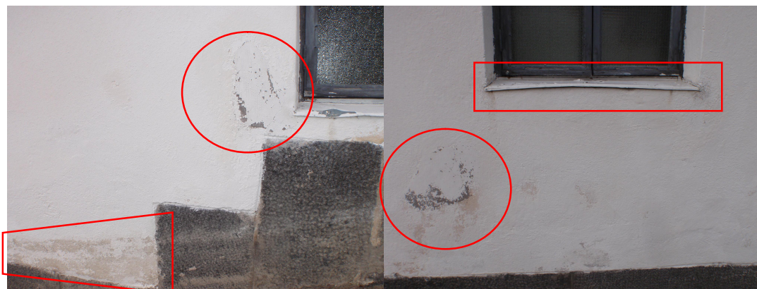
KUVIO 10. Julkisivuissa olevia virheitä ja vaurioita
