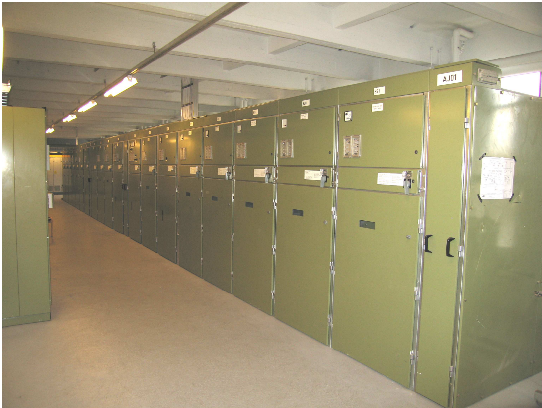
20 kV:n kytkinlaitos AJ01 (Malmö)
