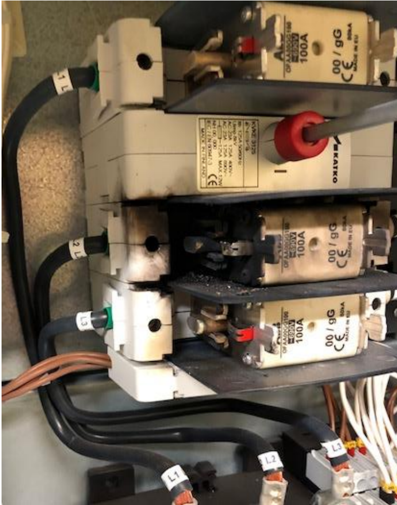
KUVA 4. Vaurioitunut pääkytkin 690 V keskuksella
