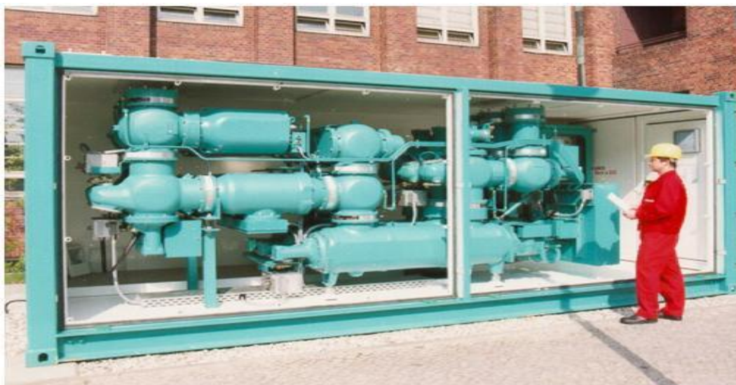
Kuva 16. Mobiilikojeisto sijoitettuna konttiin
