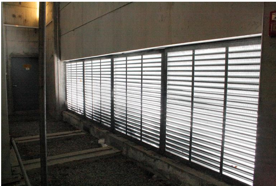
Kuva 12. Esimerkki muuntajabunkkerin eläinsuojauksesta
