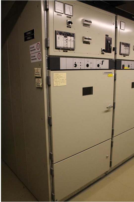
Kuva 13. 20 kV kojeiston kenno
