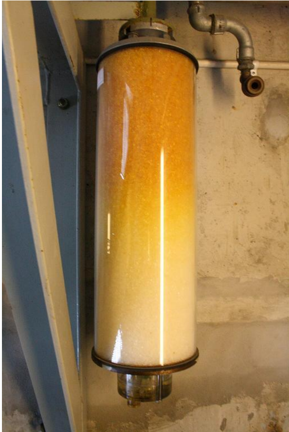
Kuva 8. Muuntajan ilmankuivaimen silikaatit
