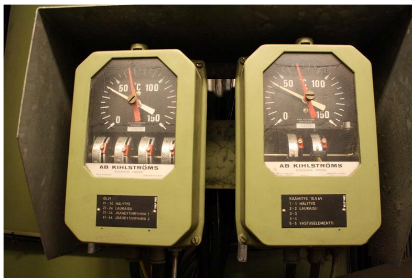
Kuva 10. Muuntajan öljyn ja käämin lämpötilamittarit
