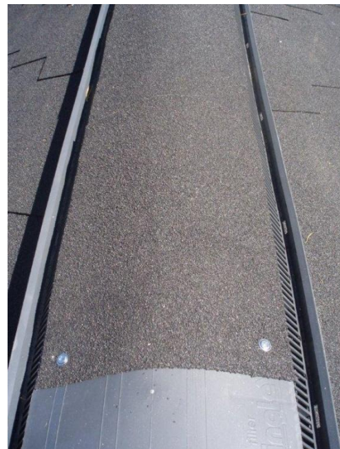
Kuva 68. Harjalle on asennettu harjatuuletus venttiili. Vuosittain kannattaa tarkistaa, että venttiili ei ole tukkiutunut puun lehdistä tai havunneulasista.
