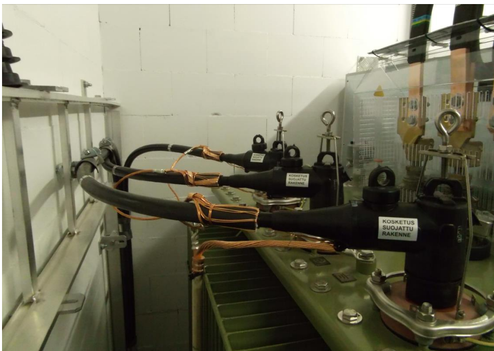
Kuva 8. Keskijännitekojeiston muuntajaliitännän kosketussuojatut päätteet muuntajan kannella.
