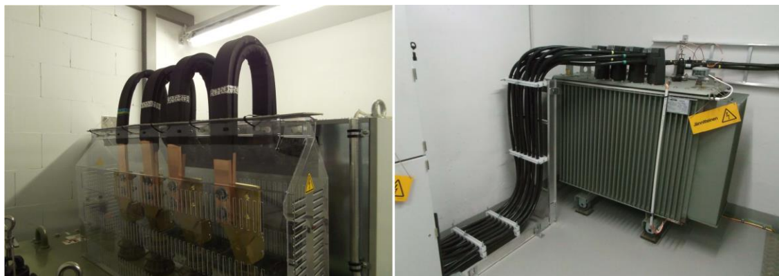
Kuva 9. Pienjännitekeskuksen muuntajaliitäntä virtakiskoilla (vas.) ja suurvirtakaapelijärjestelmällä (oik.) toteutettuna.
