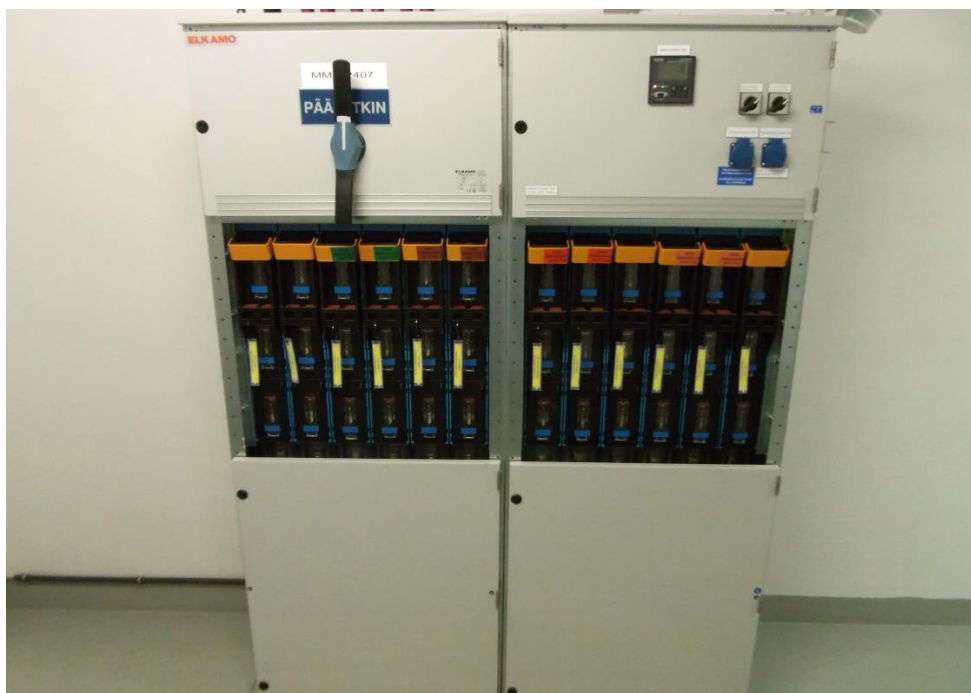
Kuva 10. Esimerkkikuva jakelumuuntamon pienjännitekeskuksesta.
