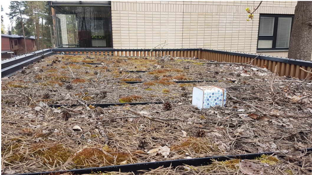
Kuva 5. Erillismuuntamon katolle kerääntyneitä roskia.
