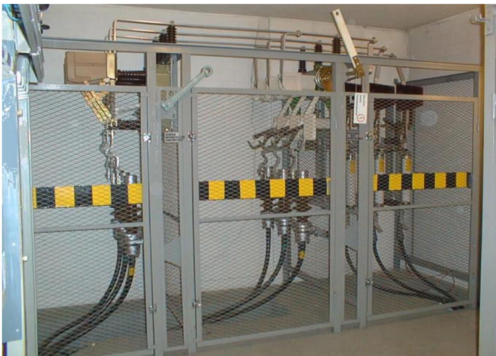
Kuva 6. Vanha avorakenteinen muuntamon keskijännitekojeisto.
