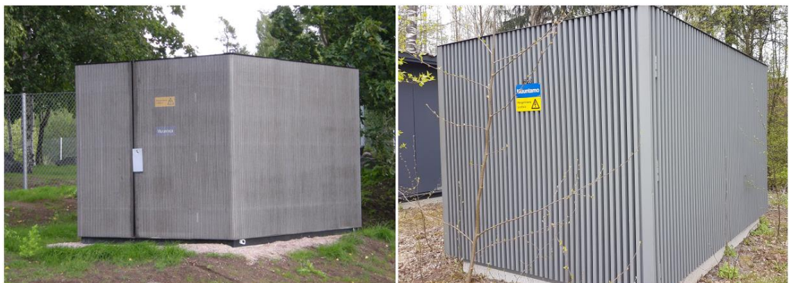
Kuva 4. HSV:n metalli- ja puuverhoillut erillismuuntamomallit.
