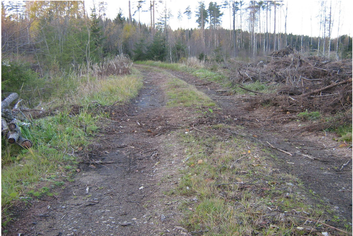
KUVA 1. Niukka päällysrakennekerros on sekoittunut hienojakoiseen pohjamaahan
