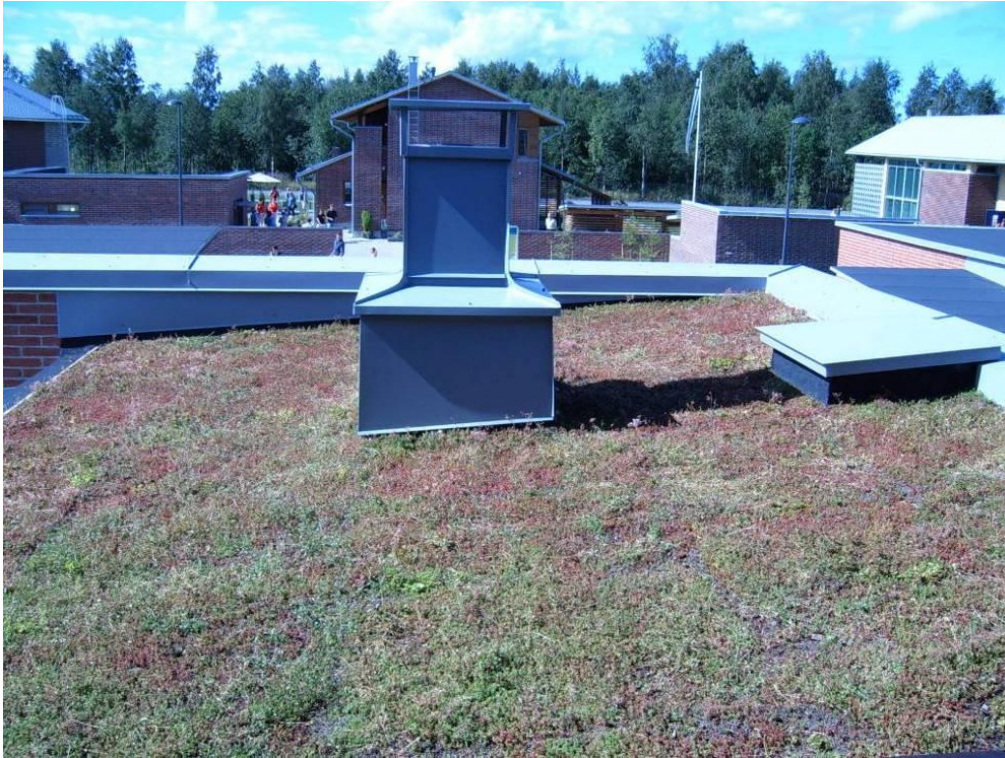
Kuva 5. Ilmaston muutoksen huomioivaa kattorakentamista Oulun asuntomessuilla 2005. Katolle on istutettu kuivuutta sietäviä kasveja, kuten sammalia ja maksaruohoja. (Kuva Rovio)
