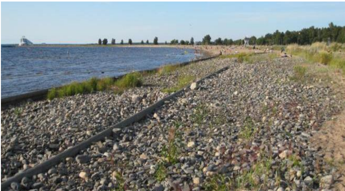
KUVA 1. Hiekka on kulunut pois ja paljastanut karkeammat maa-ainekset sekä rannan tukirakenteet. Nallikarin rannan eteläosa kesällä 2007.
