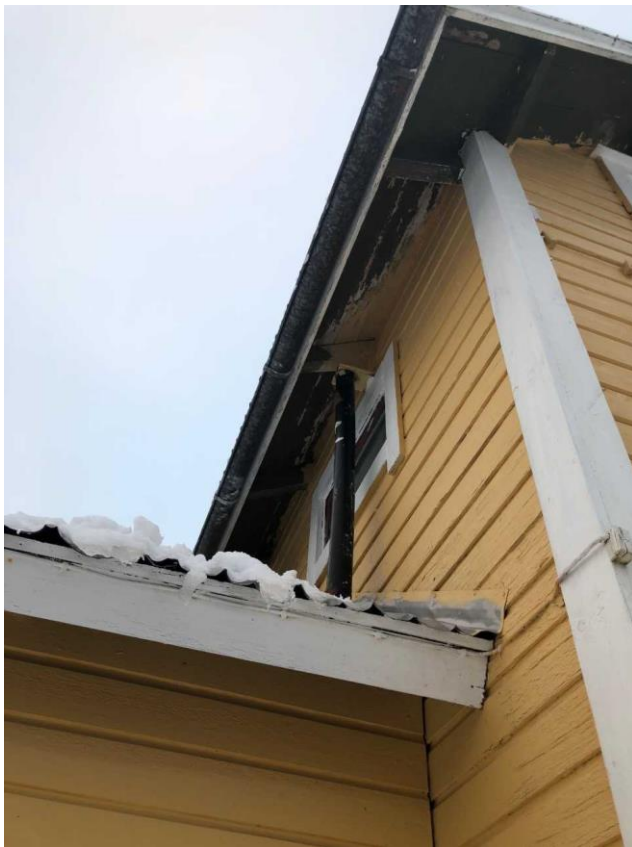
Kuva 7. Puutteelliset sadevesijärjestelmät (Vuori 2018-12-15)
