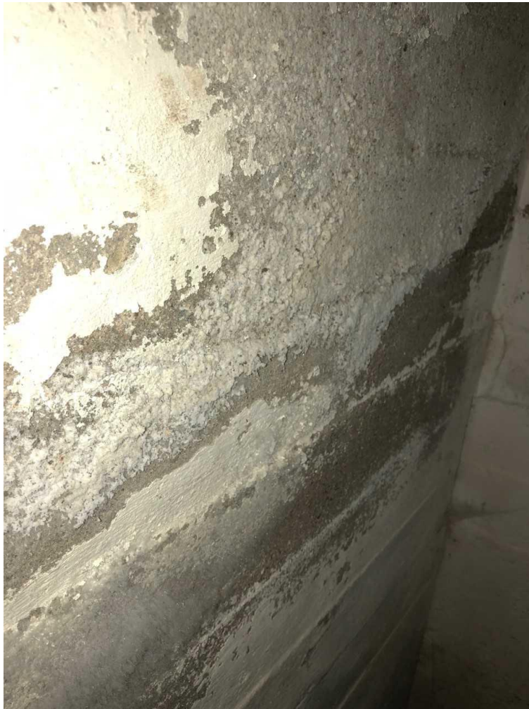
Kuva 3. Kalkkihärmää kellarin seinässä. (Vuori 2018-12-15)
