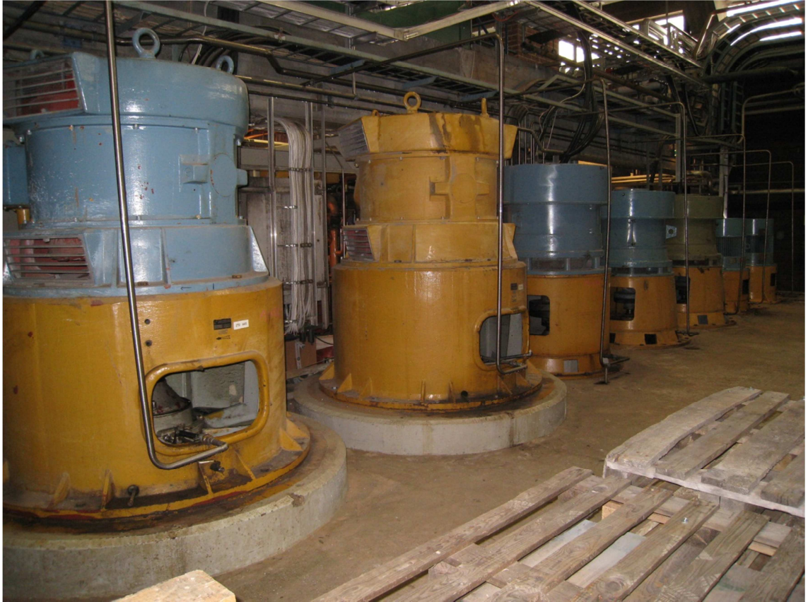
Kuva 5.2 Makrovesipumppujen sähkömoottorit sekä aukko josta vierintälaakerien värähtelymittaukset suoritetaan.
