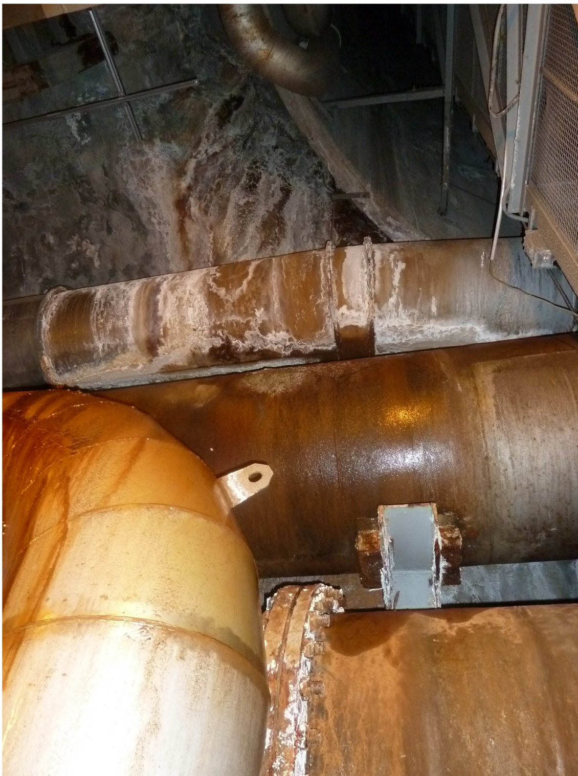
Kuva 6.3 Kallioluolaan tihkuva vesi tippuu suoraan raakavesiputkiston päälle aiheuttaen kannakkeiden syöpymisen.
