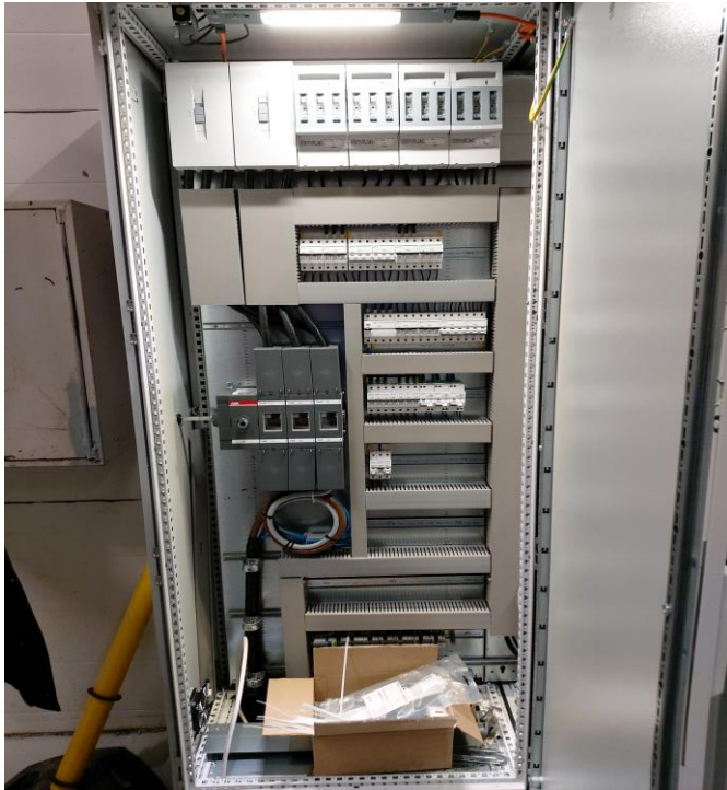
Kuva 10. LK2 sähkö- ja logiikkakeskuksen syöttö (Tupler Oy:n tuotantotilat 2020)
