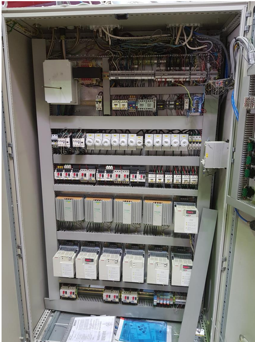
Kuva 2. Vanha linja 7 sähkökeskus (Tupler Oy:n tuotantotilat 2019)
