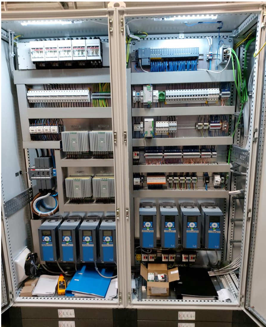
Kuva 9. LK1 eli linja 8 sähkö- ja logiikkakeskus (Tupler Oy:n tuotantotilat 2020)
