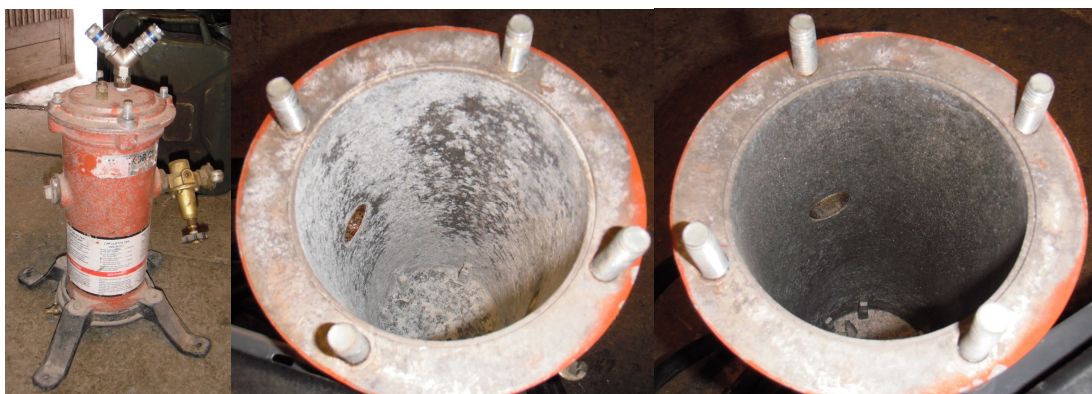
Kuva 14. Raitisilmasuodatin ulkoa päin, raitisilmasuodatin avattuna ja sisältä puhdistettu raitisilmasuodatin
