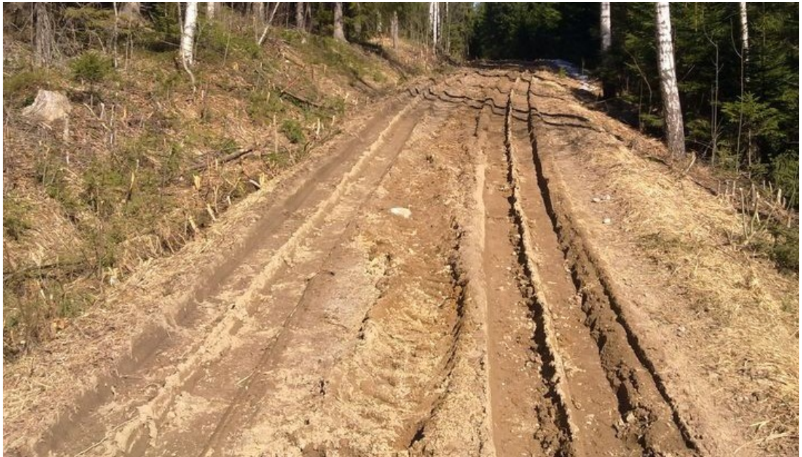
Tämän tien varrella oli tehty hakkuita ja puut oli ajettu pois oletettavasti kelirikkoai- kaan. Raiteiden keskisyvyys oli arviolta 10–15 cm (Kuva: Janne Kiiskinen 2011)
