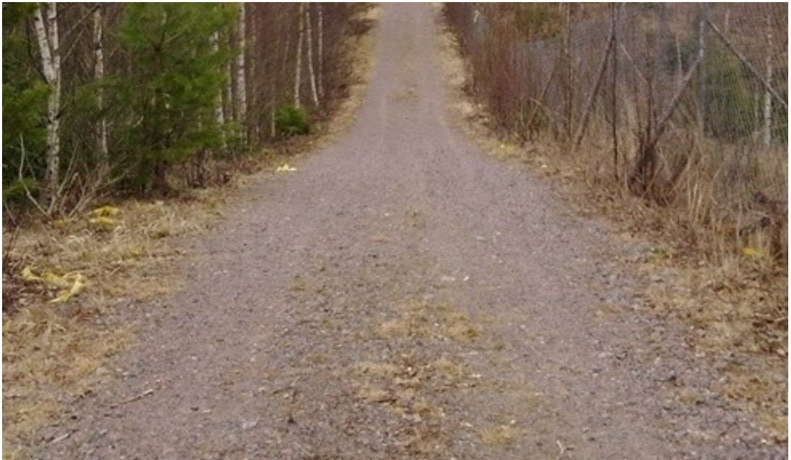
Tällä tiellä oli liian vähän pintamateriaalia ja lanaus ei olisi onnistunut (Kuva: Janne Kiiskinen 2011)
