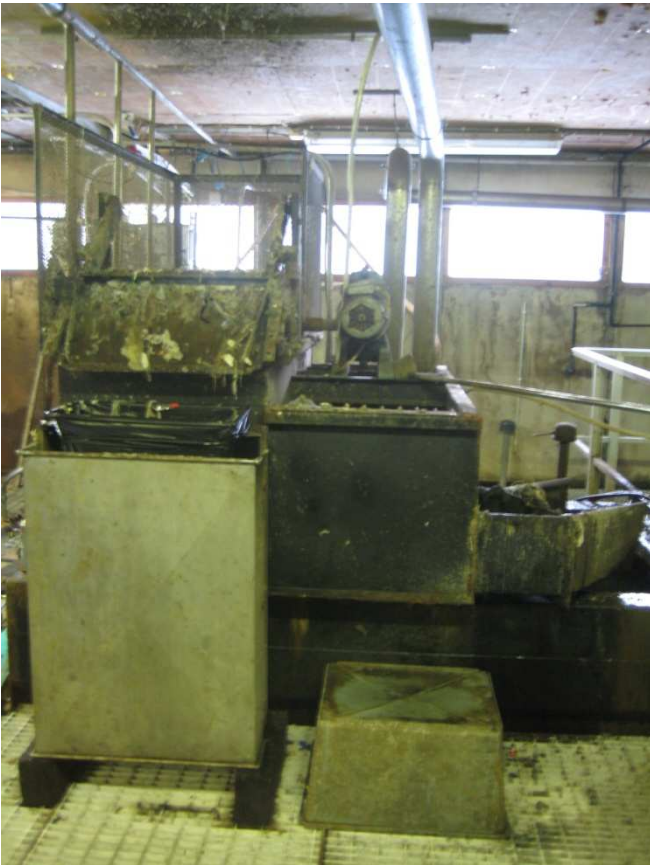
KUVA 4. Välppä ja sen alla oleva hiekan ja rasvanerotuskaivo. Valokuva Suvi Niemi 2011
