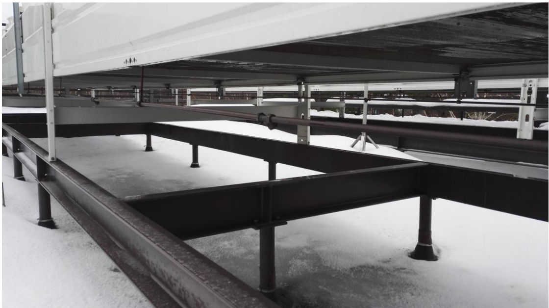
Kuva 4. Vesisumutuksen putkia Kivenlahden lämpölaitoksella [24].
