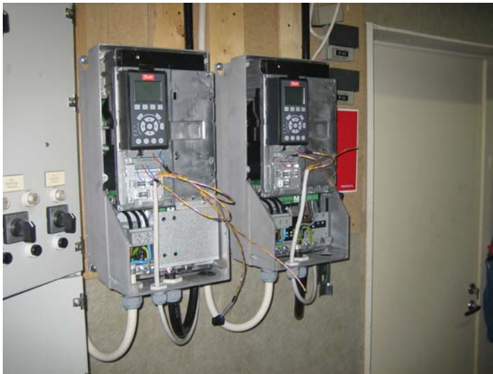
Kuva 24. Taajuusmuuttajat asennettuna seinälle ilman kansia.
